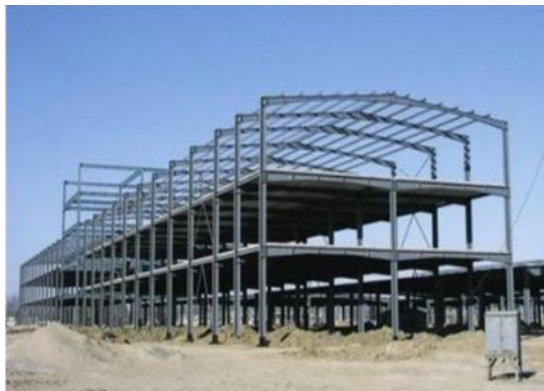
FIGURA 4.2: Esqueleto de nave industrial con estructuras galvanizadas.
