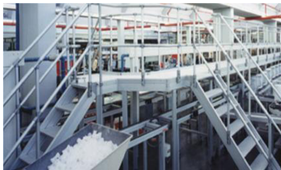
FIGURA 6.2: Las escaleras y pasamanos están propensos a sufrir golpes y ralladuras.
