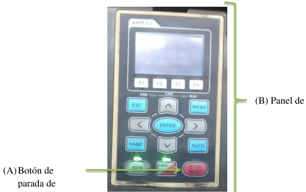
Figura 1.1 Vista del panel de pulsadores con máquina en marcha
