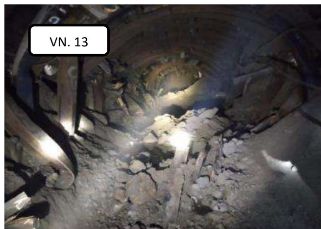
Figura 88. La presión vertical del macizo rocoso supera a las cimbras.
