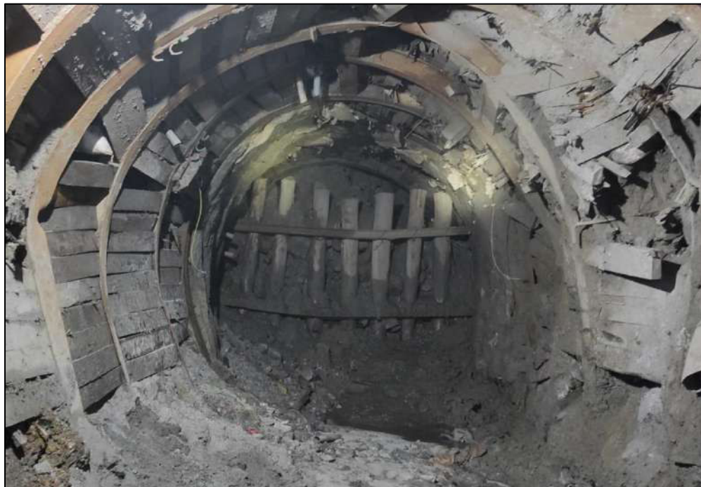
Figura 9. Deformación de las cimbras por altos esfuerzos
