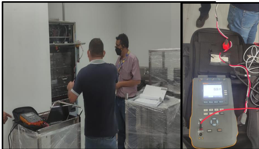
Figura 65: Prueba de Seguridad Eléctrica/ Analizador Eléctrico– Tiva10 2V. Fuente: Propia
