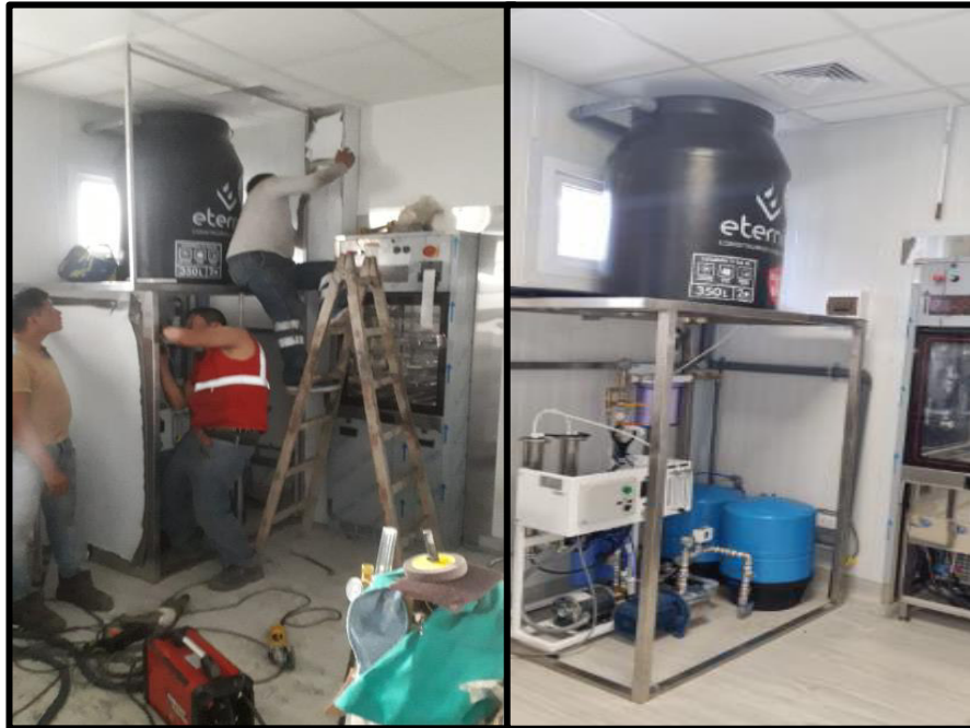
Figura 56: Instalación de Planta de Tratamiento de Agua 1. Fuente: Propia
