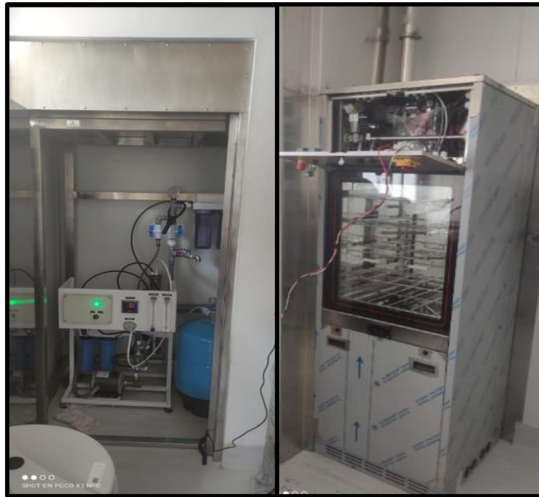
Figura 50: Instalación de la Planta de tratamiento de agua y Lavador (lado carga) – Área Roja. Fuente: Propia
