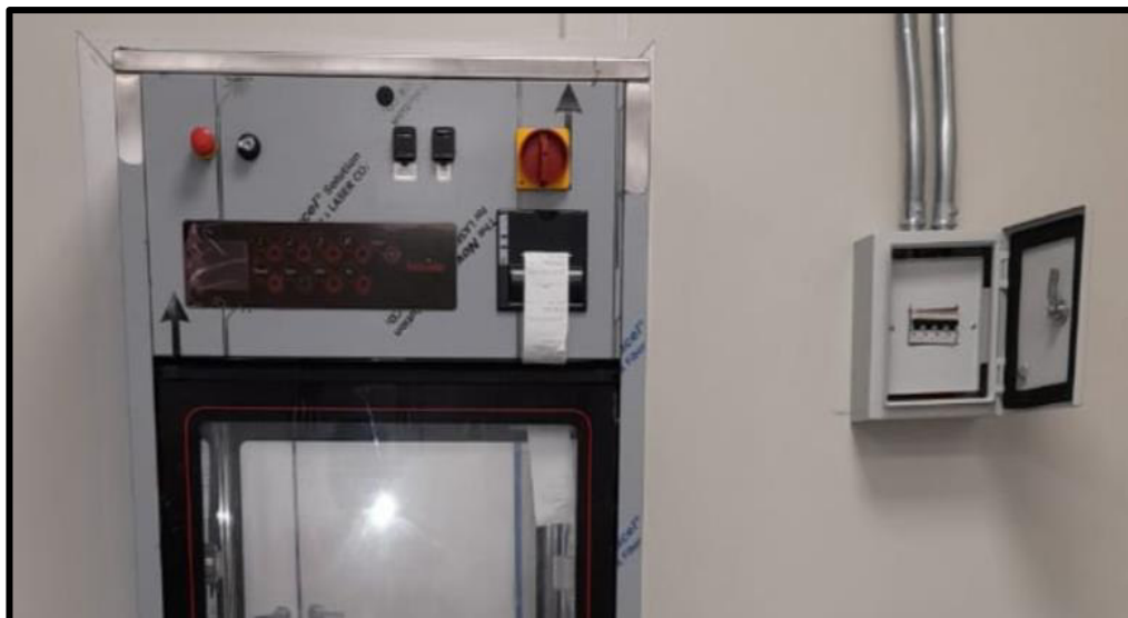
Figura 59: Verificación de conexión a Red eléctrica – Tiva10 2V. Fuente: Propia
