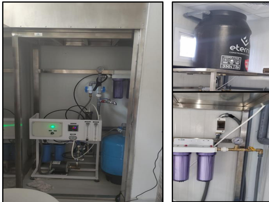
Figura 57: Instalación de Planta de Tratamiento de Agua 2. Fuente: Propia
