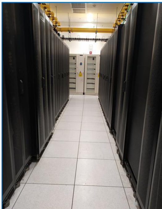
Figura 31. Gabinetes en las filas F y G del data center de Lince Fuente: Elaboración Propia
