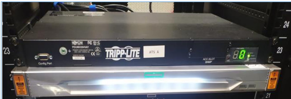
Figura 21. ATS TRIPP LITE instalado en Gabinete Fuente: Elaboración Propia
