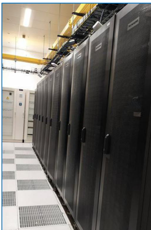
Figura 62. Vista general de gabinetes en fila G Fuente: Elaboración Propia
