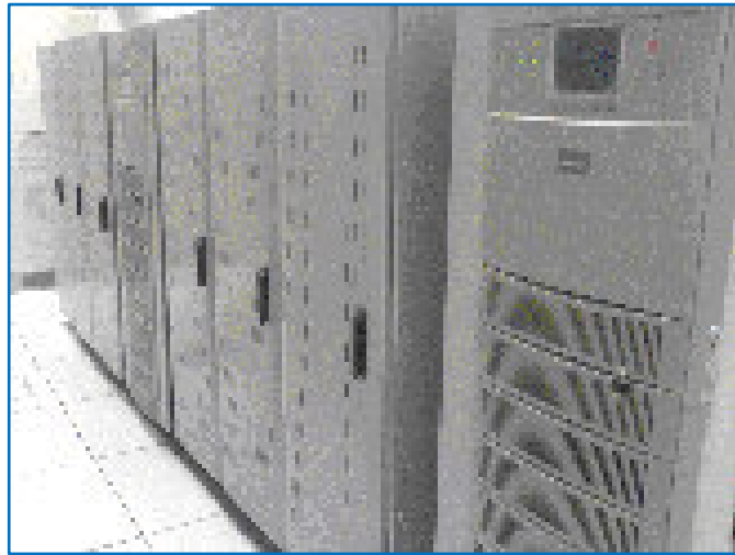
Figura 15. Sistema de Alimentación de Energía Ininterrumpida (UPS) Fuente: Especificaciones técnicas DC Lince
