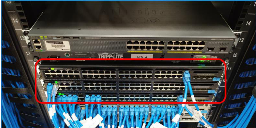
Figura 28. Switches Internet - Cisco Catalyst 3650 48T Fuente: Elaboración Propia
