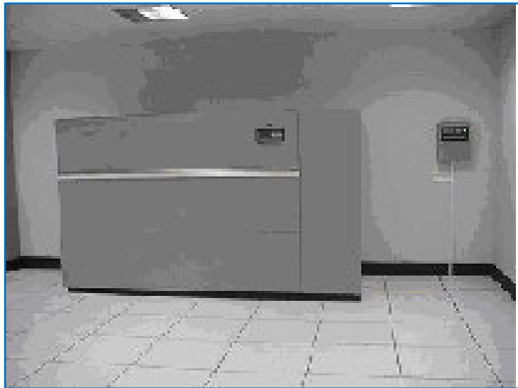
Figura 16. Sistema de refrigeración y humedad Liebert Fuente: Especificaciones técnicas DC Lince (Repositorio Telefónica)
