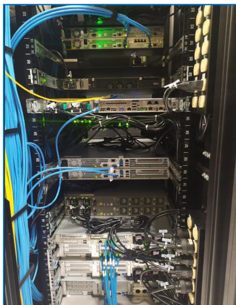
Figura 58. Vista posterior de conexión y puesta en servicio de equipos Fuente: Elaboración Propia
