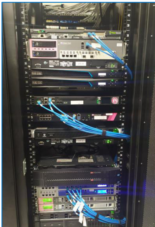
Figura 59. Vista frontal de equipos instalados y operativos Fuente: Elaboración Propia
