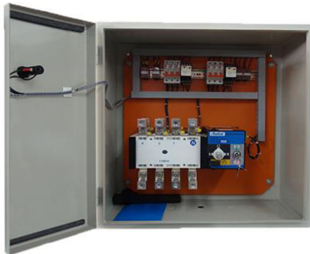
Figura 7: Tablero de Transferencia Automática. Fuente: Google Imágenes
