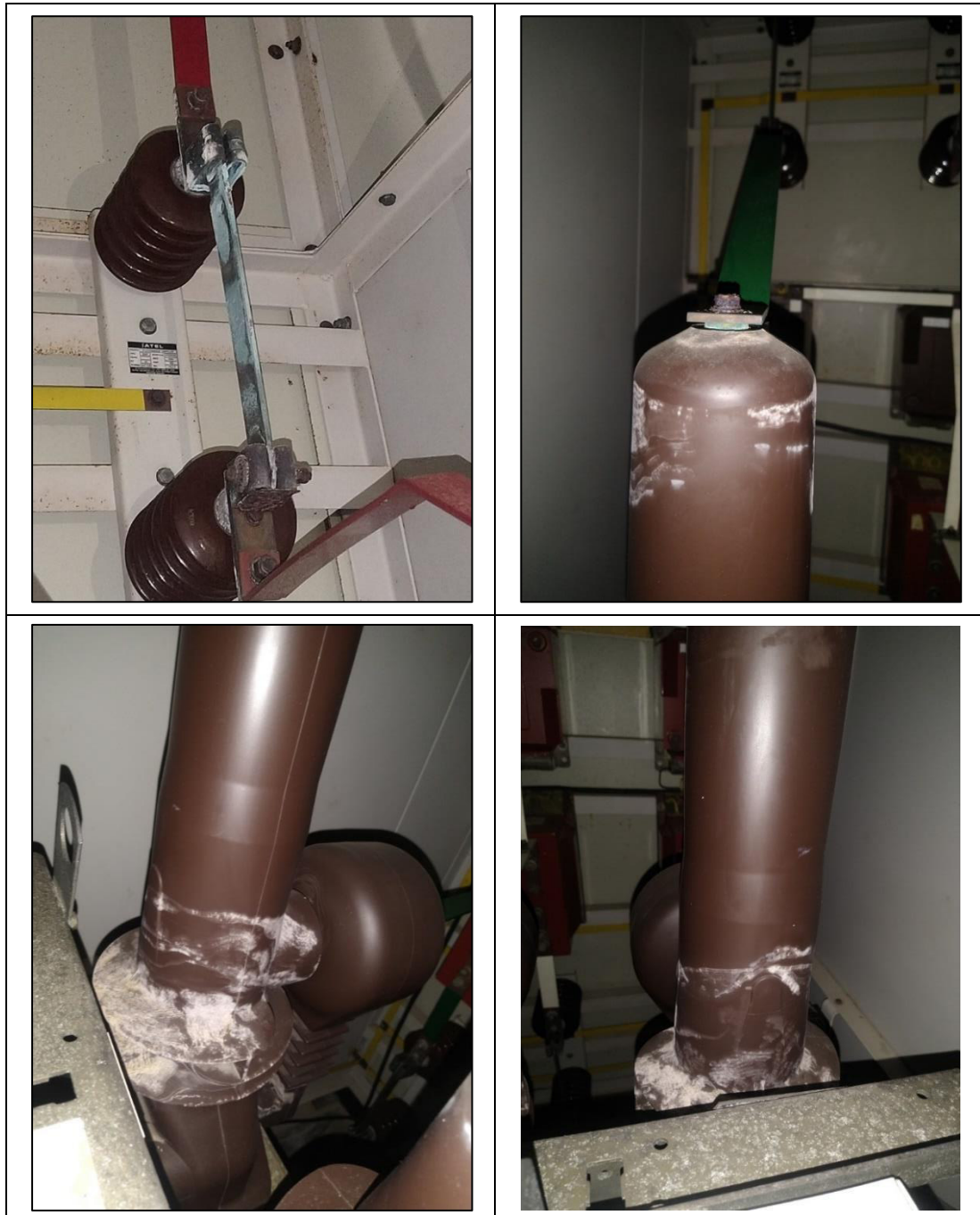
Figura 14: Fotografías de las instalaciones de las celdas convencionales con sulfatación y deterioro de aislamiento. Fuente: Elaboración Propia
