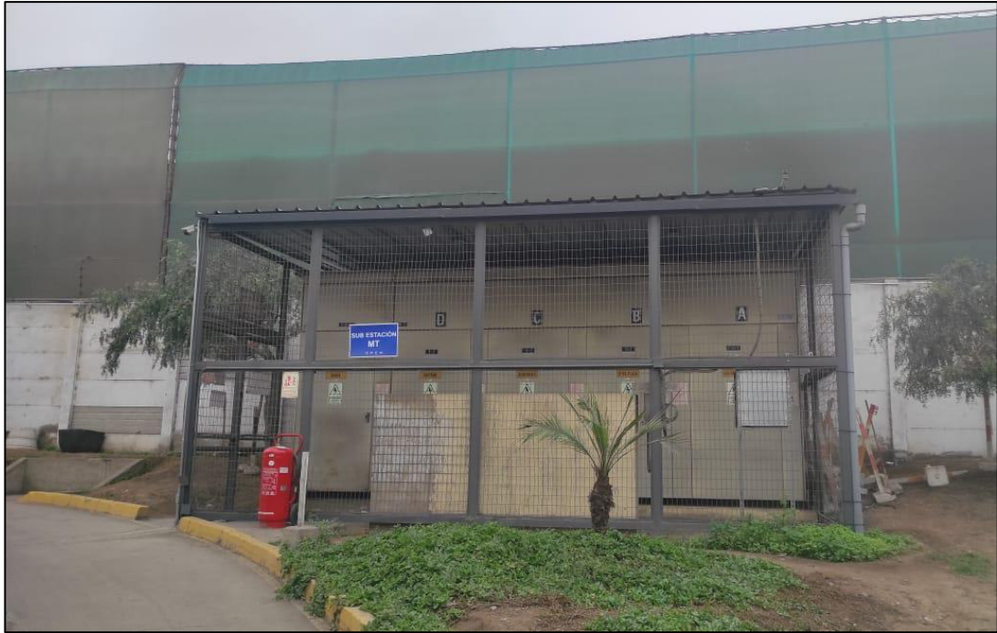
Figura 2: Subestación Eléctrica en 10.0 kV Centro Comercial Open Plaza Atocongo. Fuente: Elaboración Propia.
