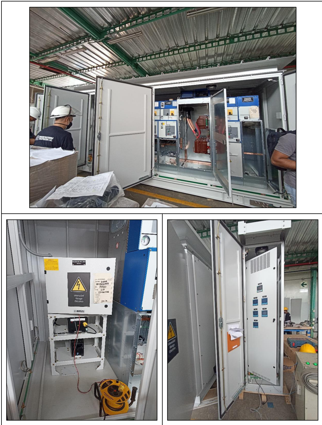
Figura 18: Supervisión del montaje terminado de las Celdas GIS en la Instalaciones de MANELSA. Fuente: Elaboración propia.
