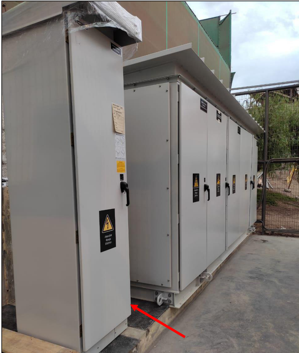
Figura 12: Instalación de Tablero autoportado de medición. Fuente: Elaboración Propia.
