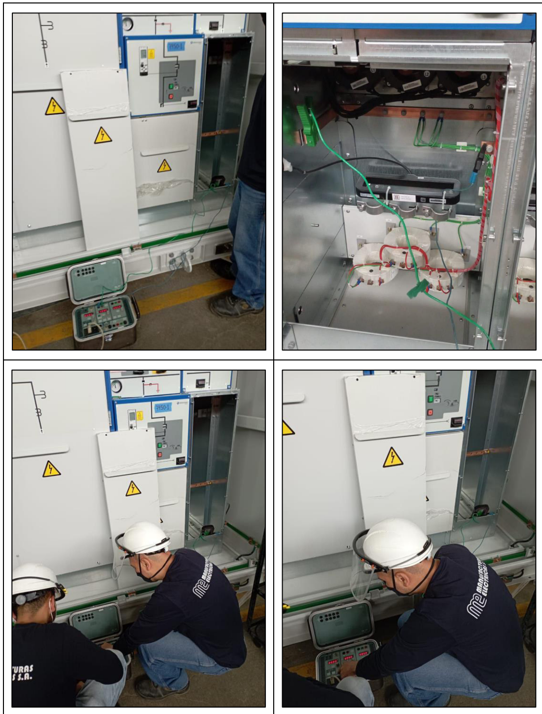
Figura 17: Supervisión de pruebas eléctricas de las Celdas GIS en la Instalaciones de MANELSA. Fuente: Elaboración propia.
