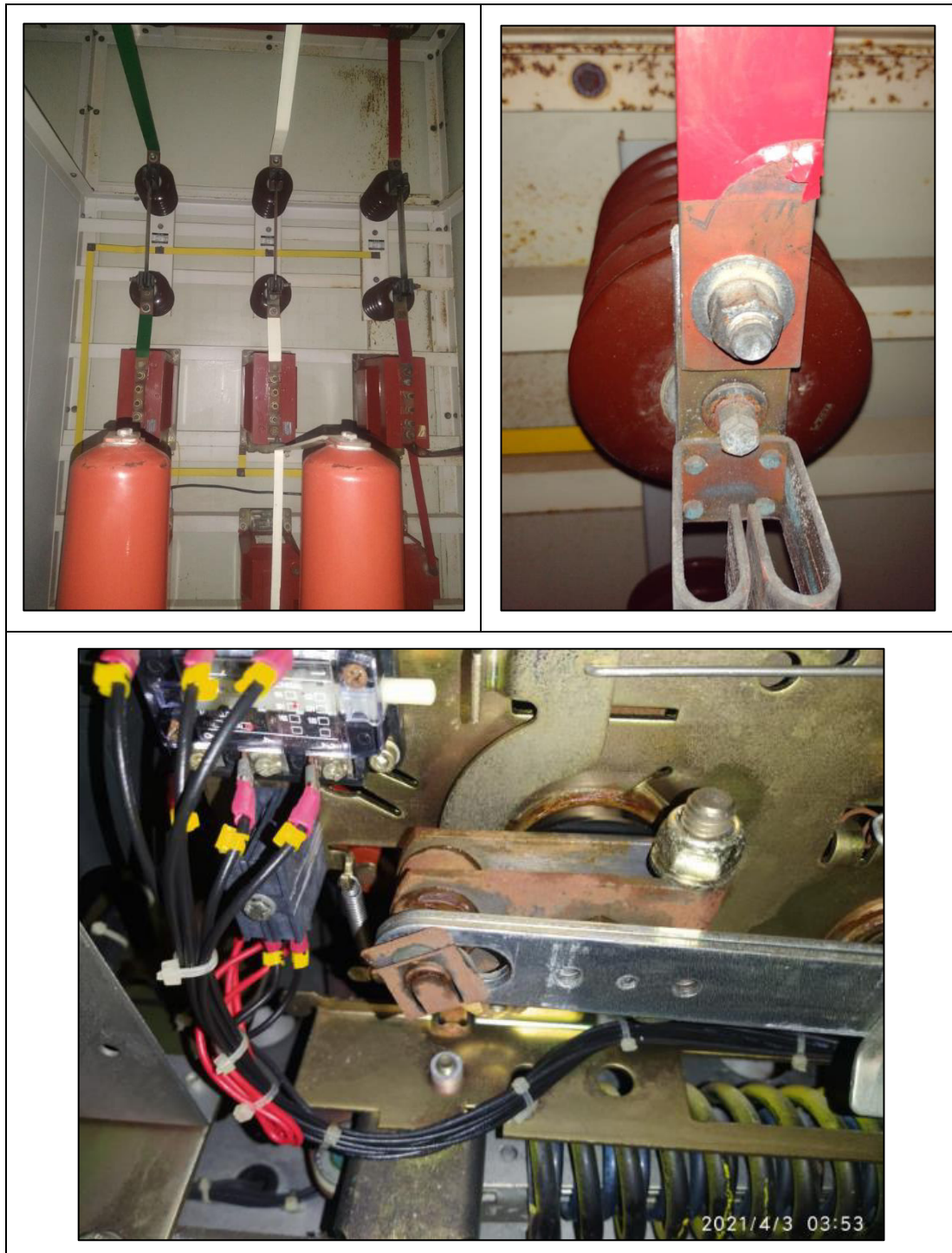
Figura 15: Fotografías de las instalaciones de las celdas convencionales con corrosión. Fuente: Elaboración propia.
