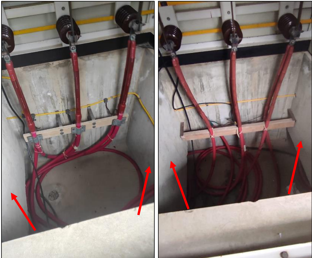
Figura 6: Muros del buzón de cables a demoler. Fuente: Elaboración Propia.
