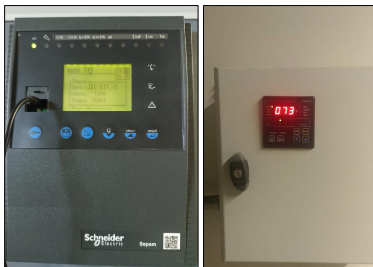
Figura 22: Relé de protección y módulo de temperatura en servicio. Fuente: Elaboración propia.
