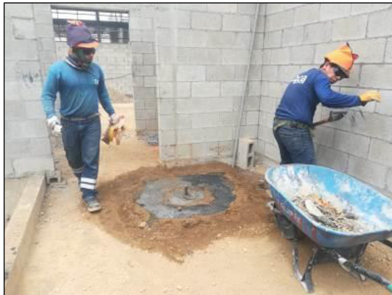
Figura 12: Pozo a tierra de neutro de media tensión y media tensión en la subestación N°1 y N°2. Fuente: Elaboración propia.
