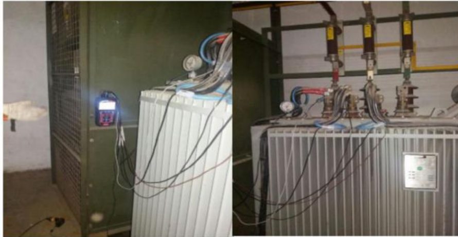
Figura 6: Analizador de carga MI-2892 instalado en Subestación. Fuente: elaboración propia.
