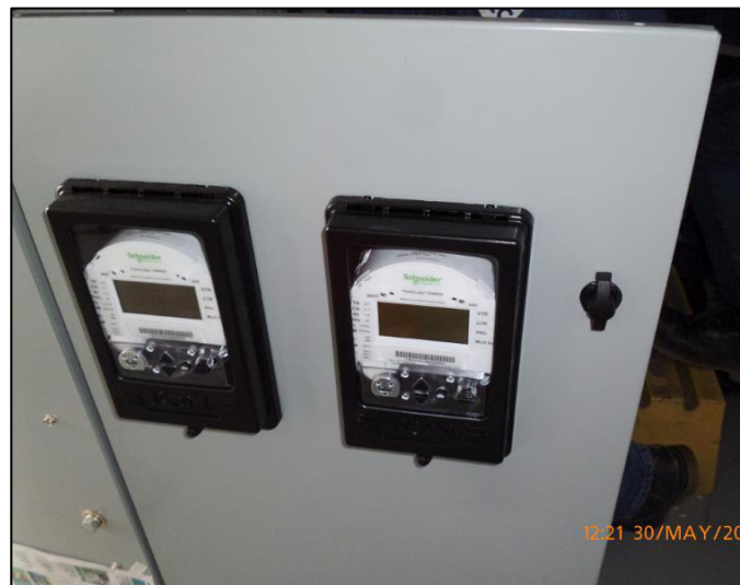
Figura N° 4.4 Instalación de Medidores Multifunción ION8650
