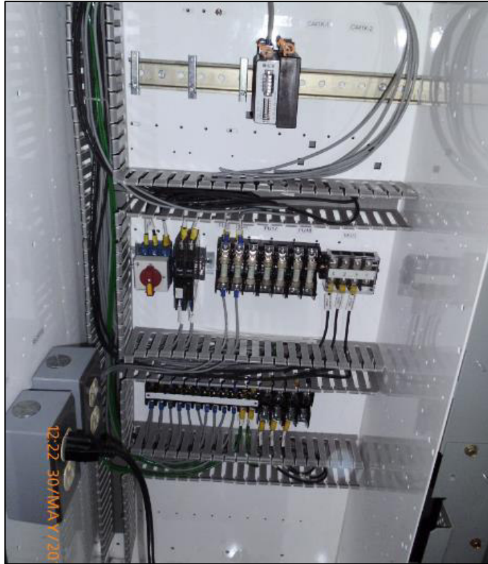
Figura N° 4.5 Cableado y conexionado del circuito de Control
