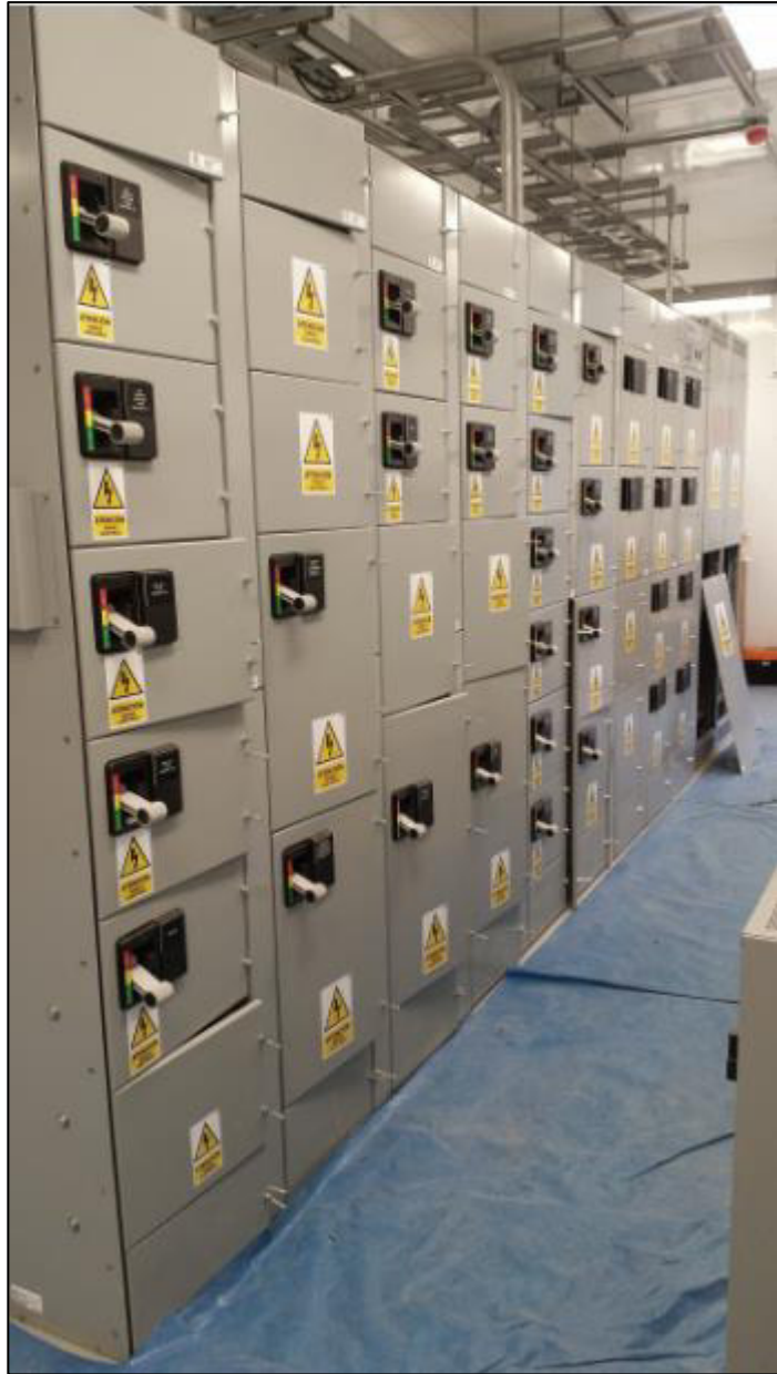
Figura N° 4.15 Centro de Control de Motores BT – Vista Posterior
