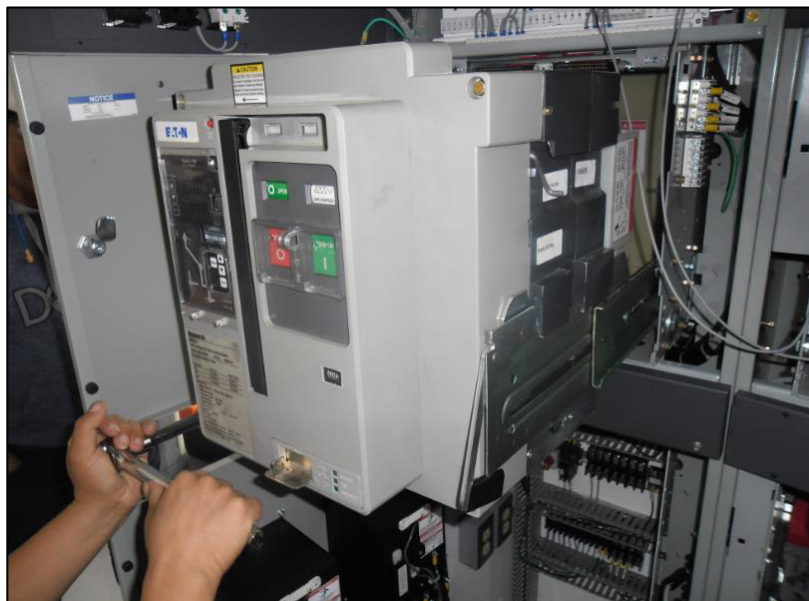
Figura N° 4.8 Instalación de Interruptor Principal - Magnum DS
