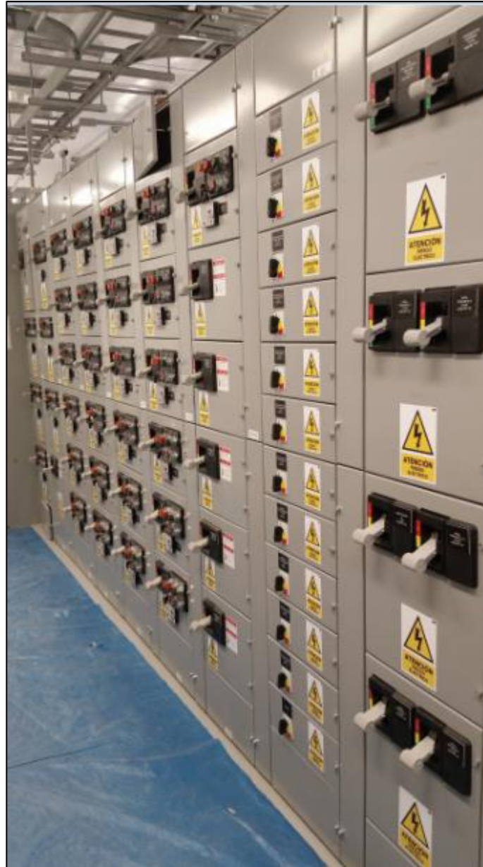
Figura N° 4.14 Centro de Control de Motores BT – Vista Frontal
