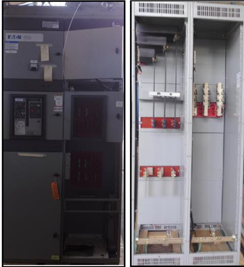
Figura N° 4.2 Vista Frontal y Posterior del Switchgear
