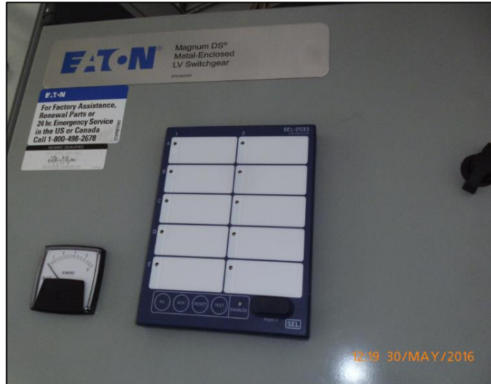
Figura N° 4.3 Instalación de Panel de Alarmas SEL2533
