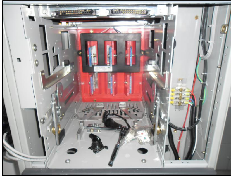
Figura N° 4.7 Cubículo para montaje de Interruptores Magnum (Eaton)
