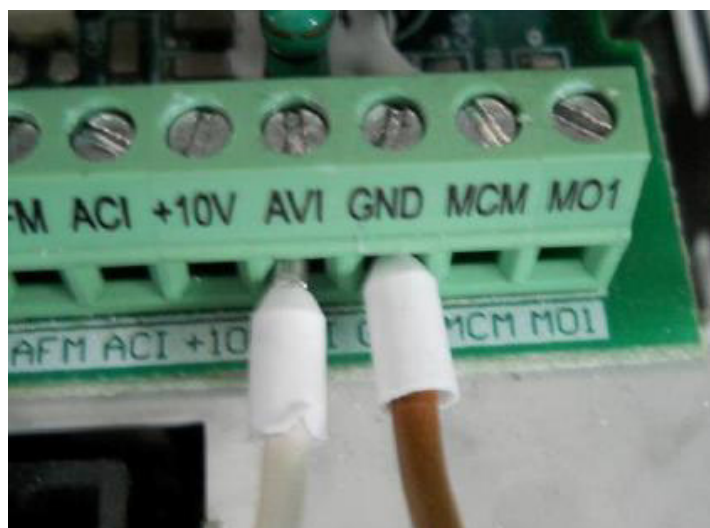
Figura 24. Conexiones del inversor a la mainboard. Fuente: Actividad laboral
