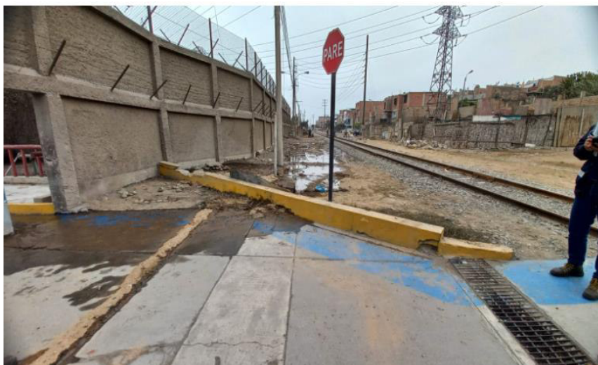
Figura 3: Cables subterráneos de Media Tensión afectados por rotura de tubería de SEDAPAL. Fuente: Enel Perú
