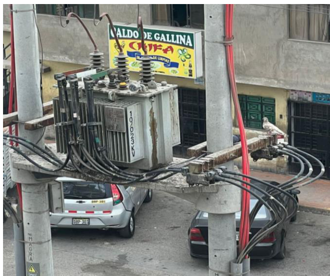
Figura 1: Subestación aérea de Media Tensión afectada por desechos de palomas. Fuente: Enel Perú
