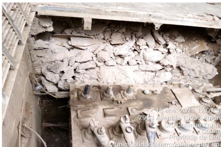
Figura 5: Bushing descargado en subestación compacta tipo subterránea en Media Tensión. Fuente: Enel Perú
