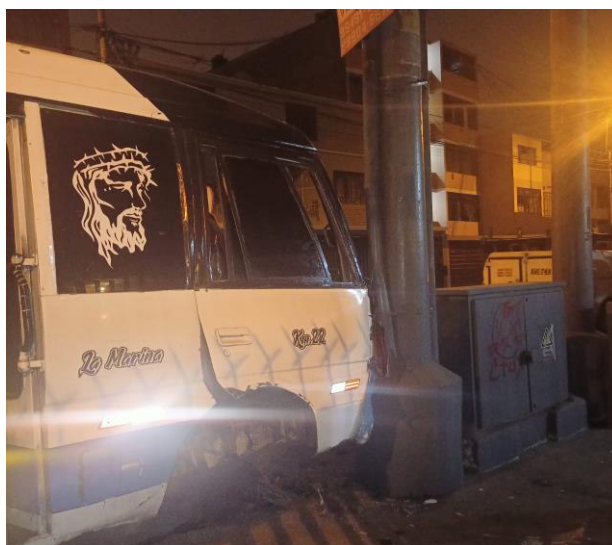
Figura 4: Choque vehicular con una Subestación Aérea en Media Tensión, el cual causó interrupción de suministro eléctrico. Fuente: Enel Perú
