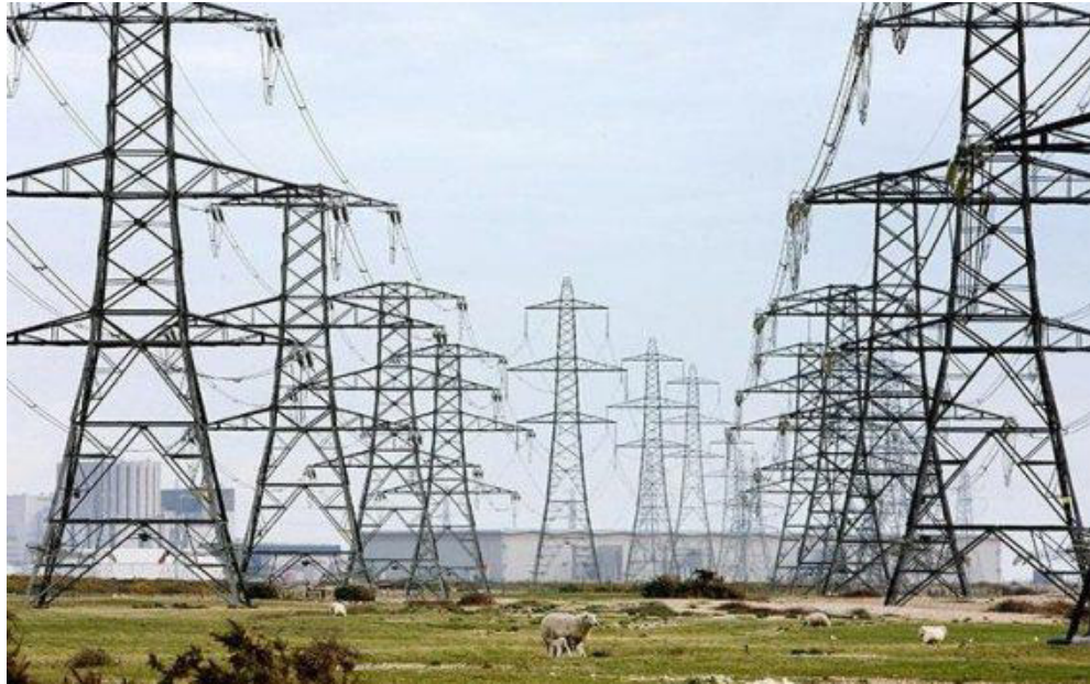
Figura 6 Torres de Alta Tensión
