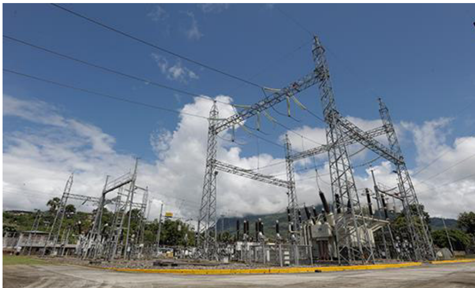
Figura 4 Subestación Eléctrica Pomacocha Fuente. ISA-REP, 2021 ( https://www.isarep.com.pe )
