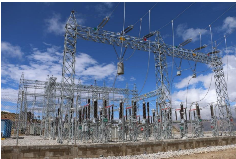
Figura 7 Patio de Llaves de una Subestación Eléctrica Fuente. Diario Gestión, 2020 ( https://gestion.pe )
