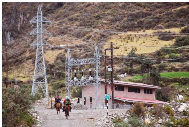
Foto 38. Instalaciones de la nueva Central Hidroeléctrica II de Rapaz, (Foto: VFH)
