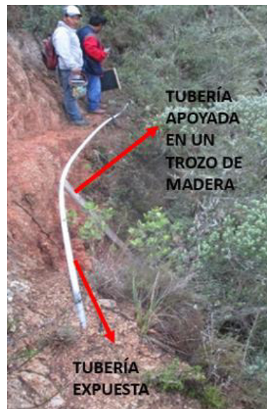
Figura 21. Línea de conducción expuesta a la intemperie. Fuente elaboración propia
