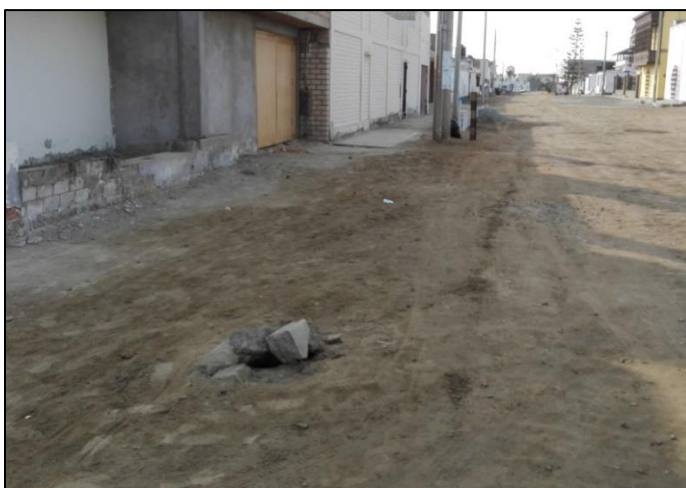
Fotografía 3.13 Clausura inadecuada de pozo ciego de desagüe, ubicada en Punta Negra Zona Sur (registro propio de setiembre, 2017).
