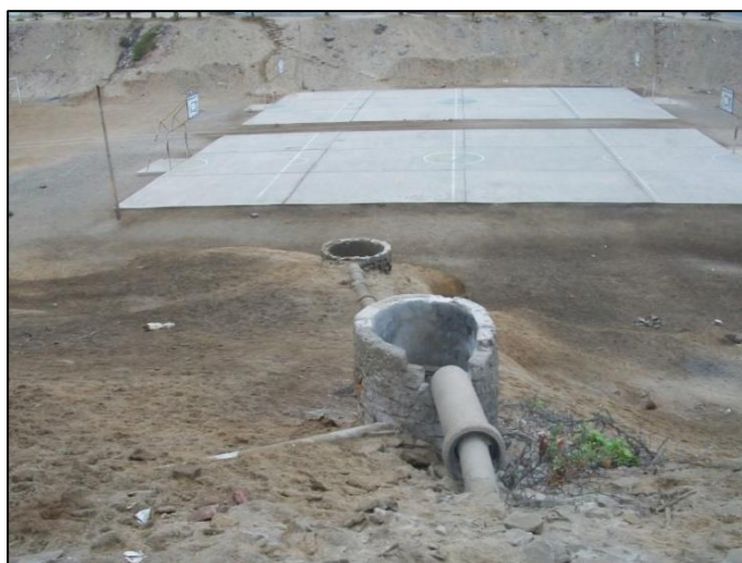
Fotografía 3.11 Conexiones de desagüe a la intemperie, ubicada en La Merced (registro propio de octubre, 2012).
