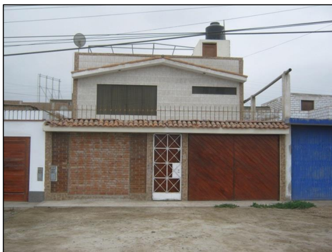
Fotografía 4.5 Vivienda de albañilería confinada (indica menor grado de vulnerabilidad por fragilidad), Asoc. de Viv. La Merced (registro propio de octubre, 2012).
