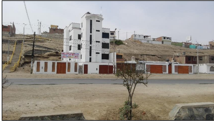
Fotografía 6.3 Estructuras que estabilicen los cortes de talud y evite deslizamientos. En la parte alta se encuentran las viviendas del AA. HH. Villa Mercedes y en la parte baja la Asoc. de Viv. La Merced (registro propio de setiembre, 2017).
