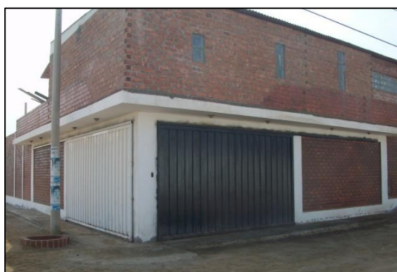
Fotografía 4.9 Vivienda con alero (indica mayor grado de vulnerabilidad por fragilidad), Cercado de Punta Negra Zona Sur (registro propio de octubre, 2012).
