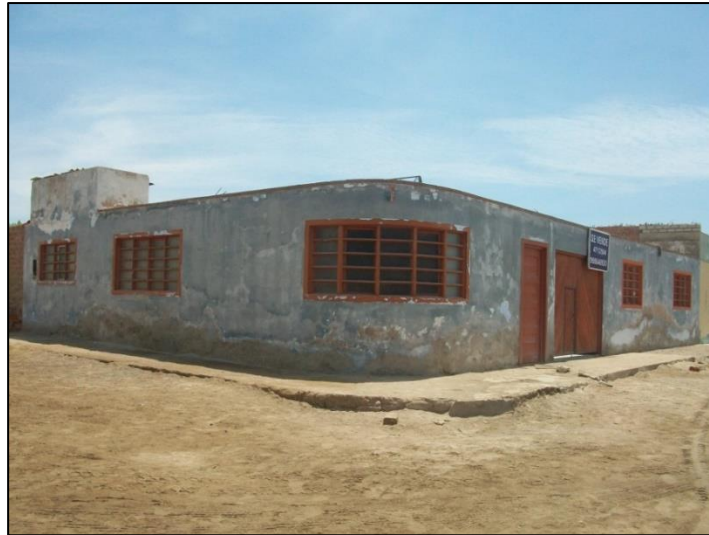
Fotografía 4.3 Vivienda en mal estado (indicador de mayor grado de vulnerabilidad por fragilidad), Cercado de Punta Negra Zona Sur (registro propio de octubre, 2012).
