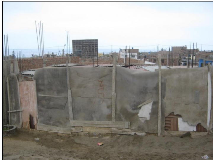
Fotografía 4.4 Vivienda de material precario (malas prácticas de hacinamiento indican mayor grado de vulnerabilidad por fragilidad), Asoc. de Viv. Costa Azul Zona B (registro propio de octubre, 2012).
