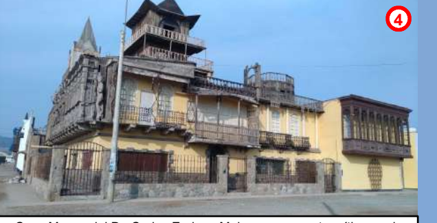
4. La Casa Museo del Dr. Carlos Enrique Melgar es un punto crítico por la antigüedad de su construcción. El museo recibe mantenimiento periódicamente pero no se refuerzan sus estructuras, siendo un peligro para sus visitantes. Registro fotográfico (23 de setiembre del 2017, distrito de Punta Negra).
