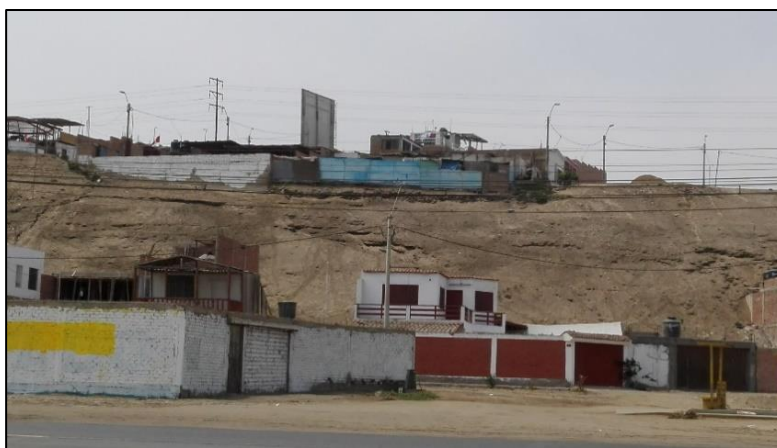
Fotografía 6.2 Viviendas sobre talud de suelos inestable y requerimiento de muro de contención. Parte superior se localiza el AA. HH. Las Lomas y parte inferior la Asoc. de Viv. La Merced (registro propio de setiembre, 2017).
