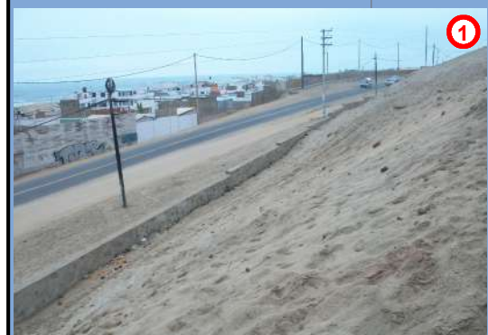
Depósito marino-aluvial T2 en el AA.HH. Villa Mercedes. Presenta material suelto que desestabiliza la ladera. Registro fotográfico (16 de noviembre del 2012, distrito de Punta Negra).
