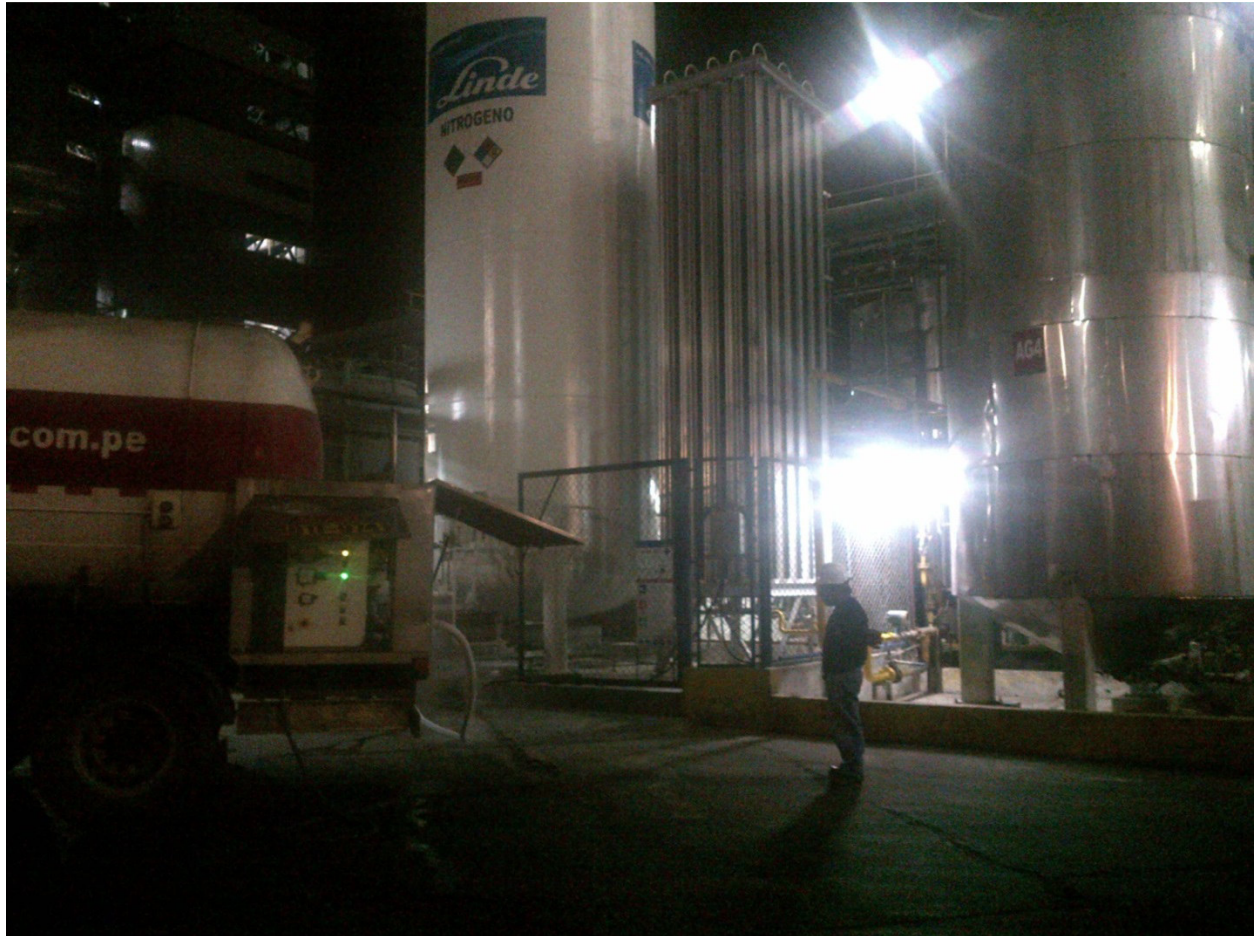
Fig. 26 Tanque Criogénico de Nitrógeno Líquido para Proceso de Blanketing
