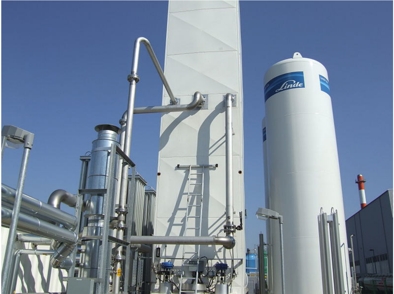
Fig. 5 Torre de Destilación de Gases del Aire ( Cold Box )
