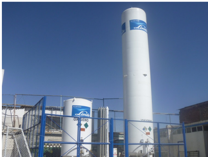
Fig. 3 Tanque Criogénico 8 de Oxígeno Líquido Medicinal
