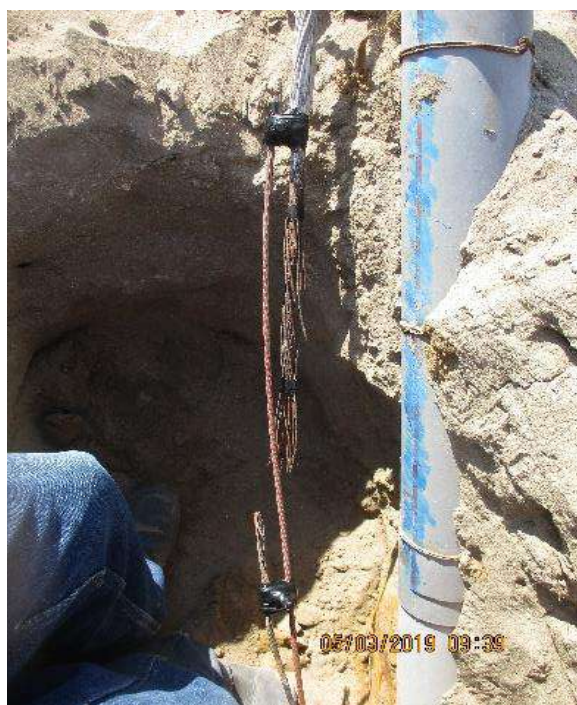
Figura 19. Conectores bimetálicos y cable copperweld. Fuente: Abengoa Perú
