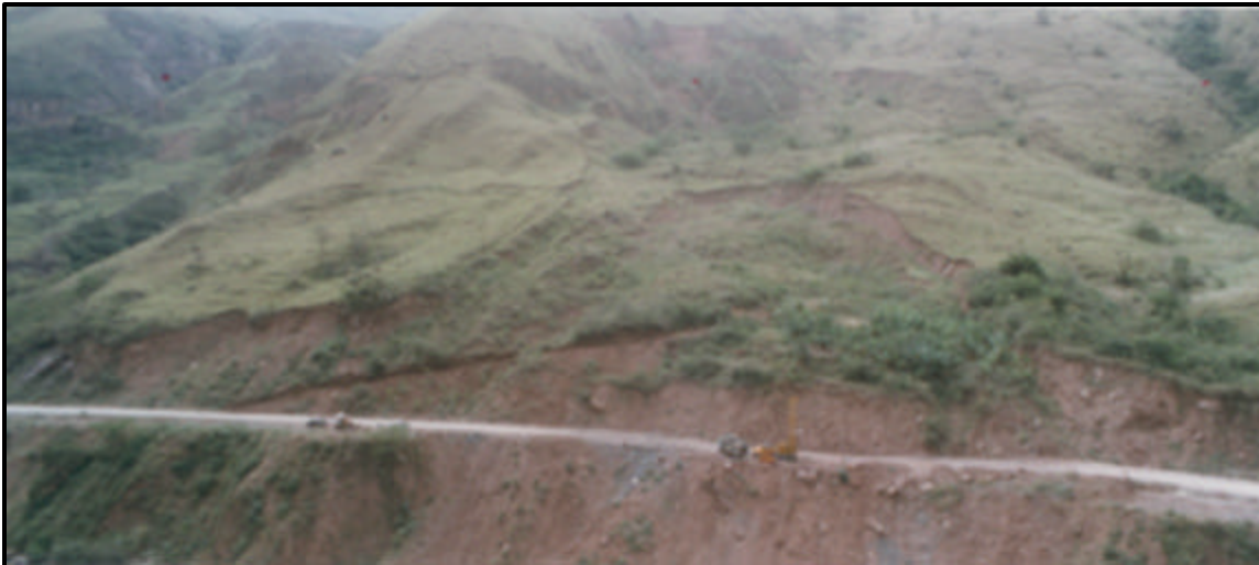
Foto 21.- Deslizamiento activo escalonado en lutitas, areniscas del grupo Mitu, en la progresiva 295+090 a 295+280
