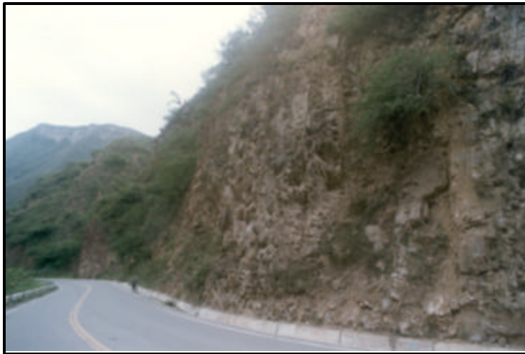
Foto 18.- Desprendimiento de bloques y bloques inestables, en calizas subverticales de la Fm. Chambará. Progresiva 297+000 (G-10)
