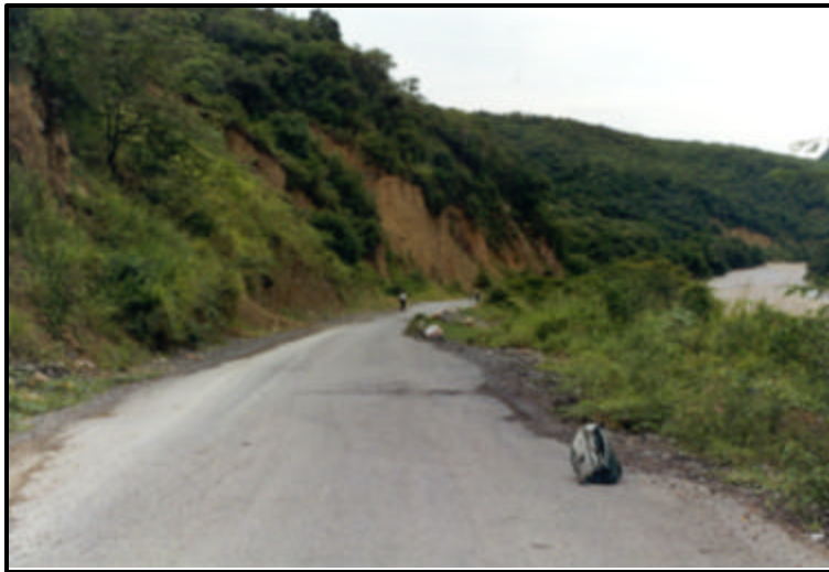
Foto 17.- progresiva 269+650, a primera vista fisuras en plataforma, tramo muy difícil, al fondo erosión de riberas con deslizamiento escalonado en lutitas y margas; plataforma dañada
