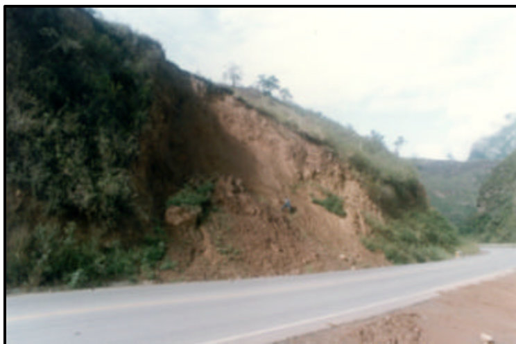
Foto 20.- Derrumbe en coluvial con matriz limo-arenoso de color rojizo; al frente ocurre erosión en las riberas en la progresiva 296+095 (G-14)
