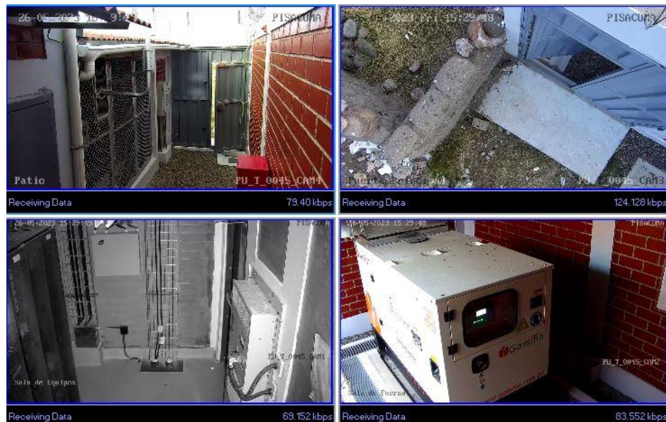
Figura 5 Sistema de Video. Nota. Vista de los ambientes del nodo de transporte (patio, frontis, sala de equipos y sala de fuerza). Fuente propia.
