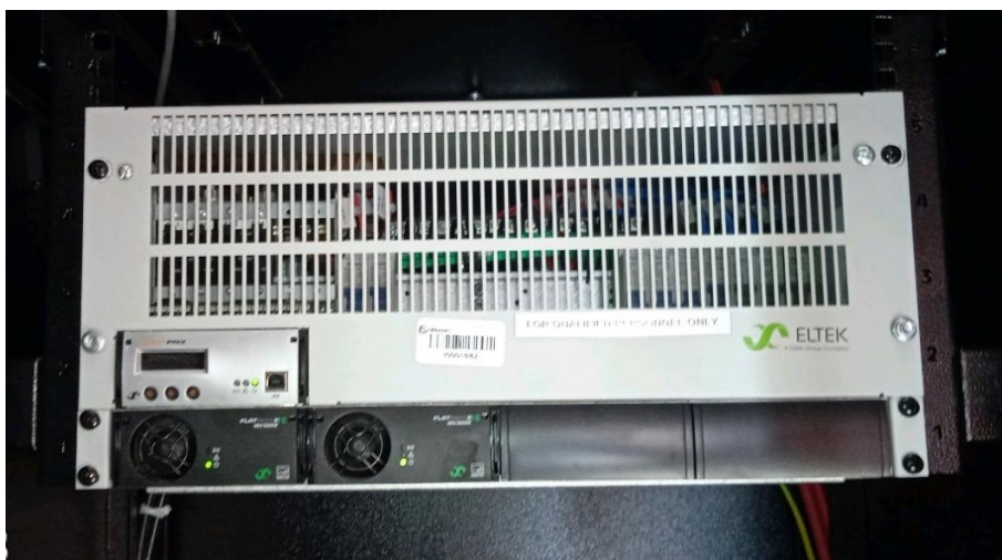
Figura 4 Equipo Rectificador/Cargador. Nota. Equipo rectificador en gabinete de la sala de equipos. Fuente propia.
