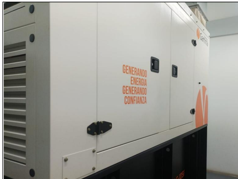
Figura 6 Grupo electrónico. Nota. Grupo electrónico en sala de fuerza del NOC de transporte. Fuente propia.
