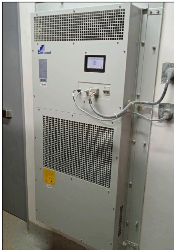
Figura 7 Aire acondicionado. Nota. aire acondicionado (HVAC) en la sala de equipos. Fuente propia.
