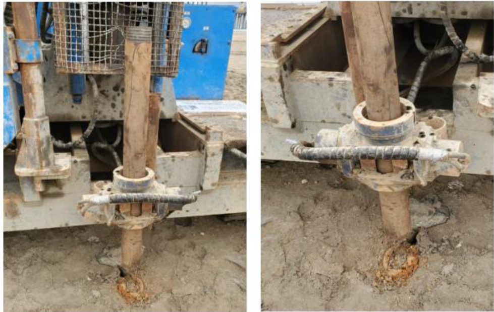
Figura 13. Sistema de Mordazas hidráulicas instaladas en las Máquinas perforadoras de MRA
