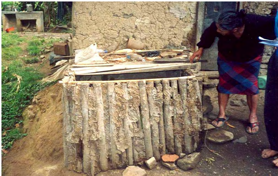
Figura 8: Poza con tapa instalada en el exterior y al lado de la vivienda
