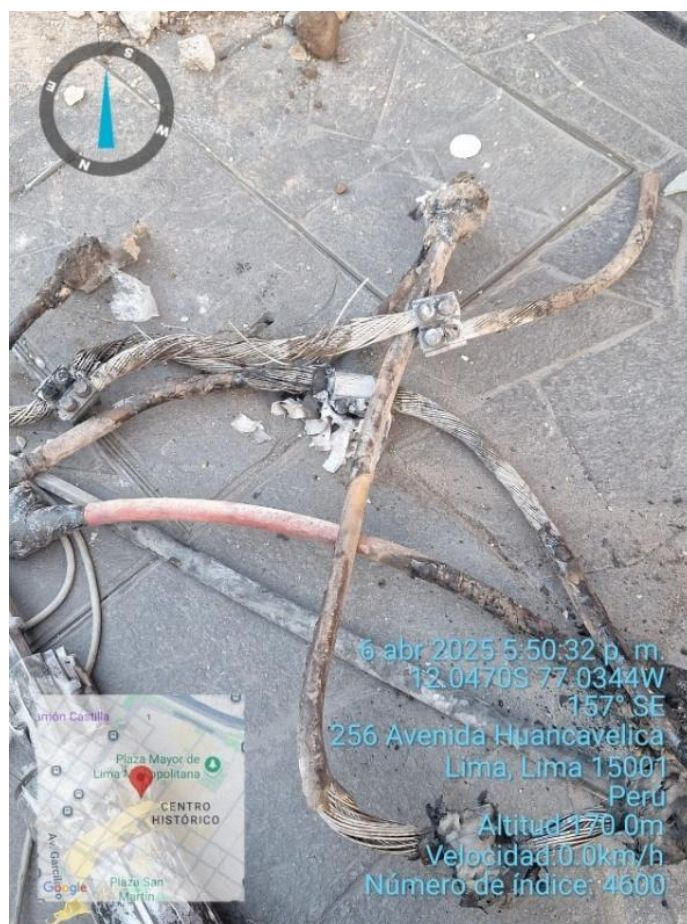
Figura 7. Sobrecarga en cable. Elaboración propia
