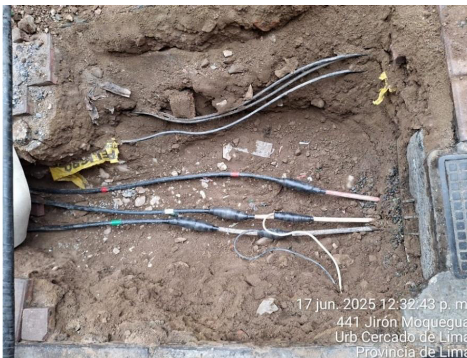
Figura 30. Empalme de derivación. Elaboración propia
