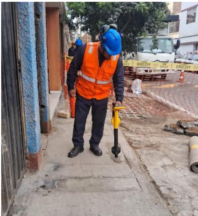
Figura 59. Uso de bastón para ubicación de falla. Elaboración propia
