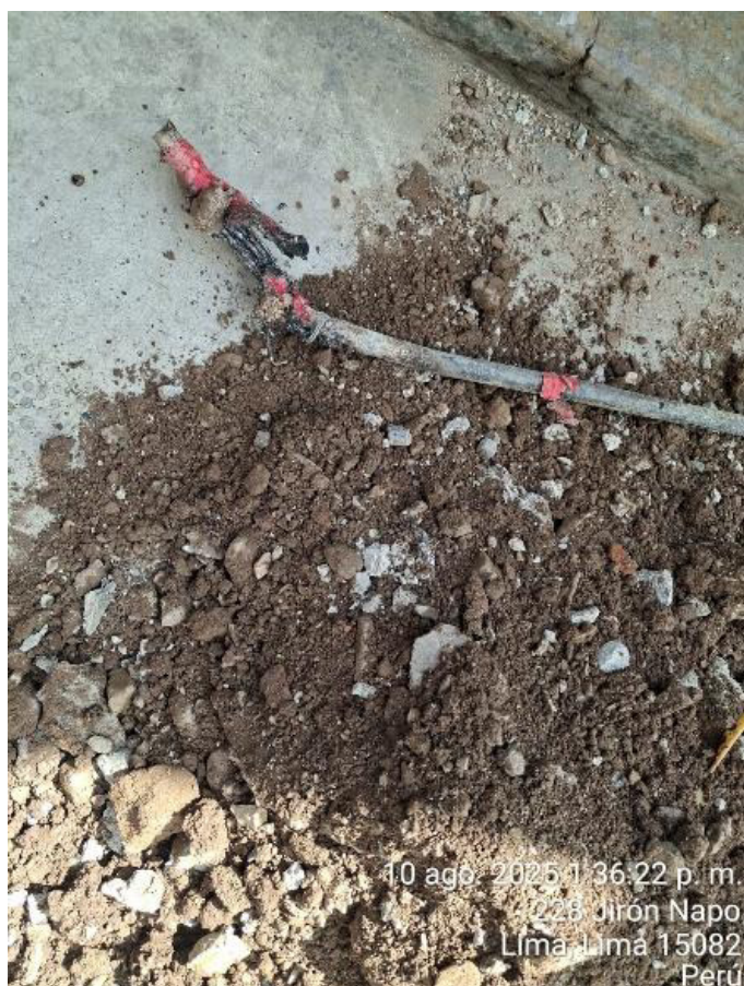
Figura 61. Falla ubicada. Elaboración propia
