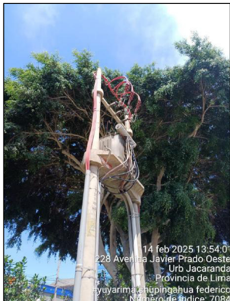
Figura 22. Subestación aérea. Elaboración propia
