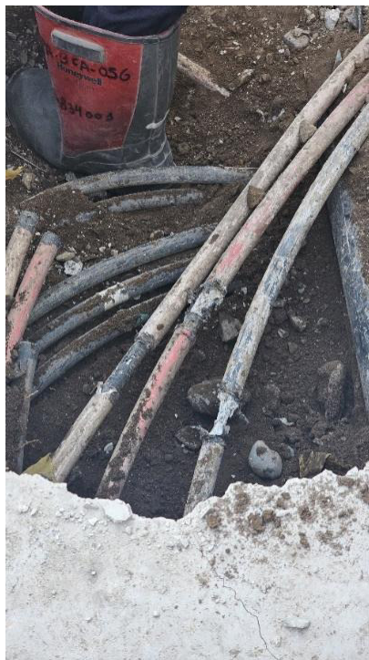
Figura 4. Degradación de aislamiento. Elaboración propia
