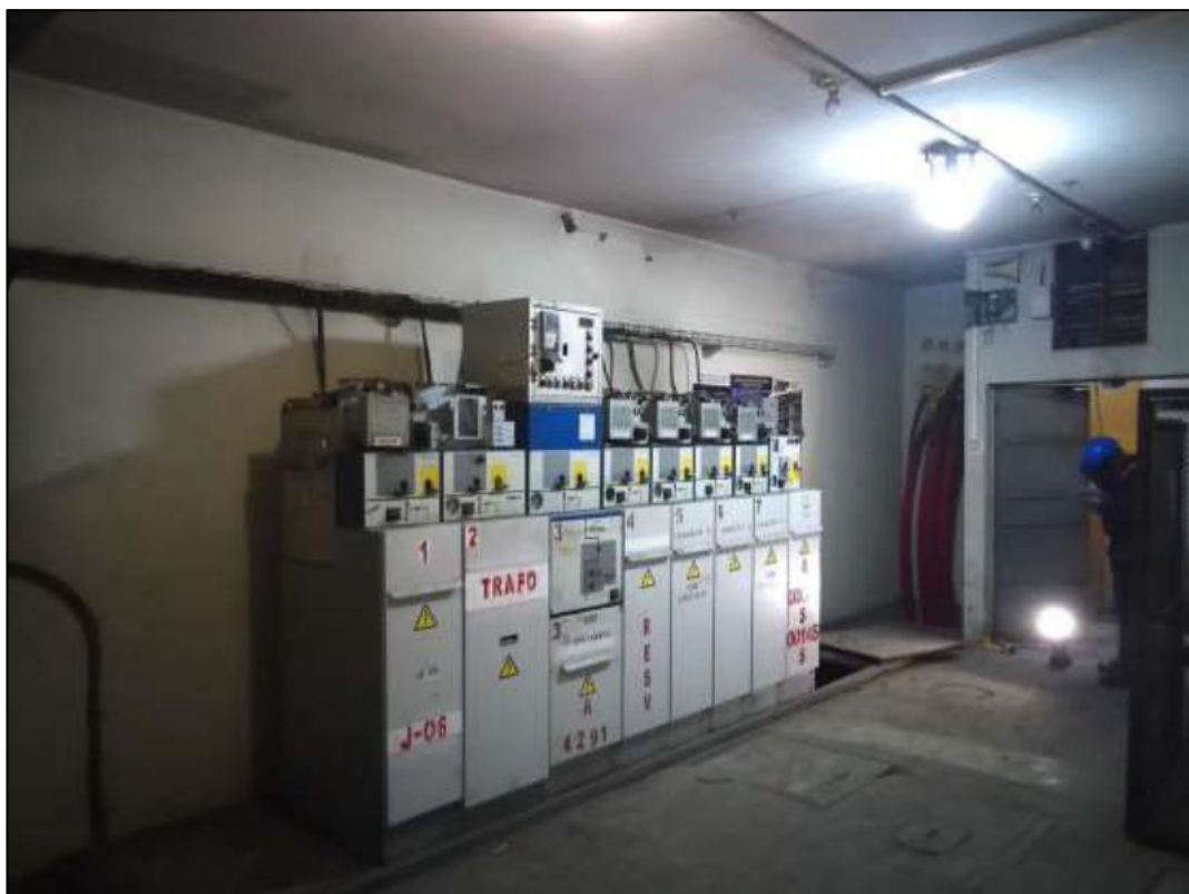
Figura 18. Subestación convencional superficie. Elaboración propia
