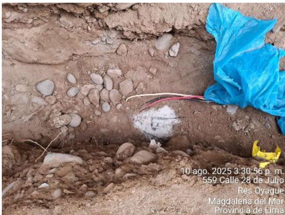
Figura 68. Falla ubicada. Elaboración propia
