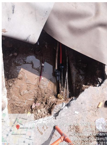
Figura 6. Filtración de agua. Elaboración propia
