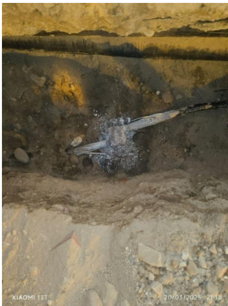
Figura 5. Falla en empalme. Elaboración propia
