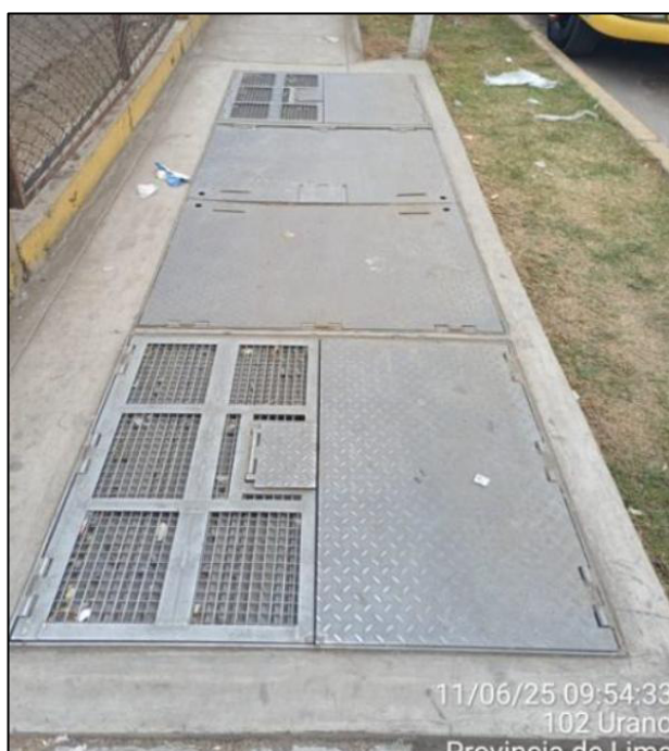
Figura 21. Subestación compacta bóveda. Elaboración propia
