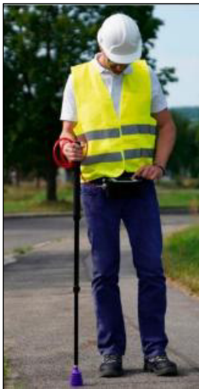
Figura 82. Detección de gases. Tomado de Megger (2025c)
