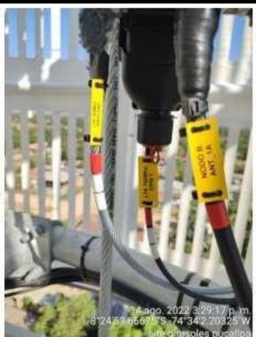
Vista de aterramiento de RRU 700 & 850 – Sector 2
