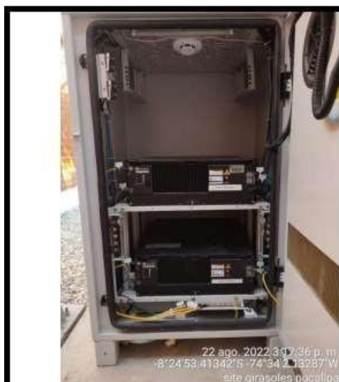
Vista panorámica de gabinete de baterías N°2
