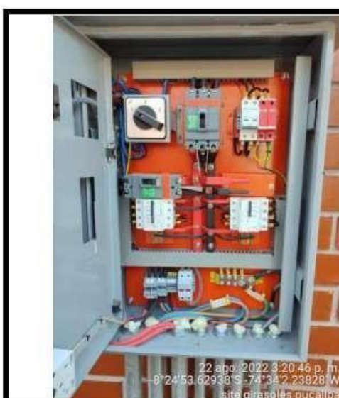
Vista de tablero PDP abierto
