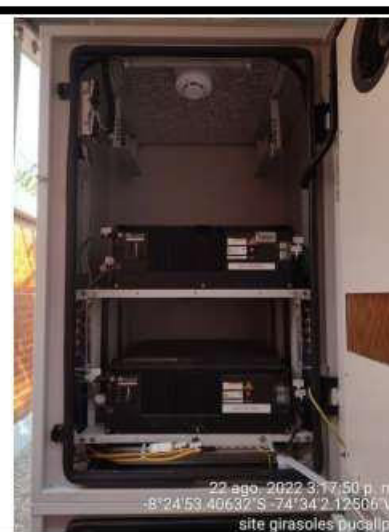
Vista panorámica de gabinete de baterías N°1
