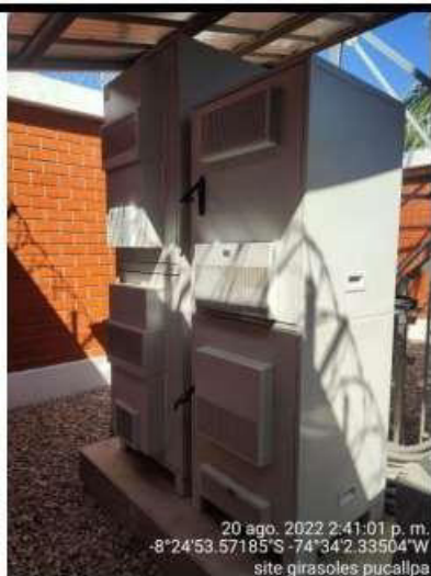
Vista panorámica de gabinetes
