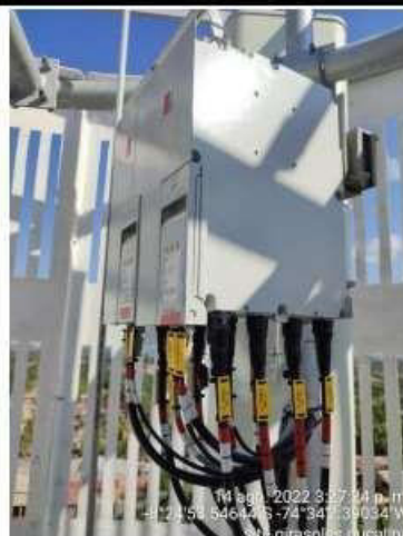
Vista de RRU 1900 – Sector 2
