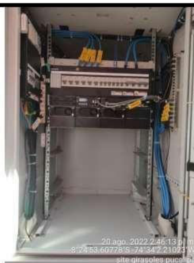
Vista panorámica de gabinete Rectificador
