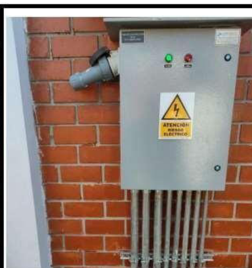
Vista de tablero PDP
