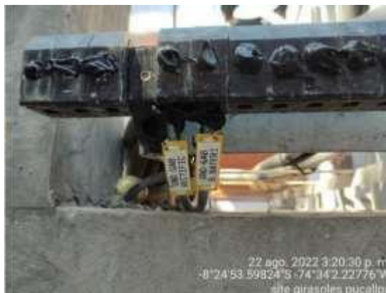
Figura 24. Aterramiento de gabinetes
