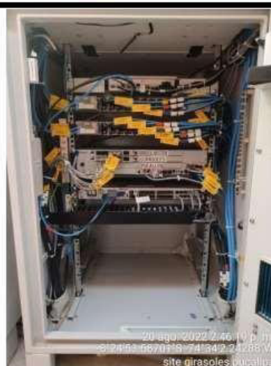
Vista panorámica de gabinete TX 1
