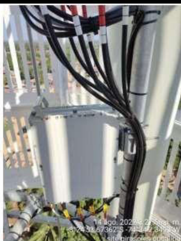
Vista de RRU 700 & 850 – Sector 2
