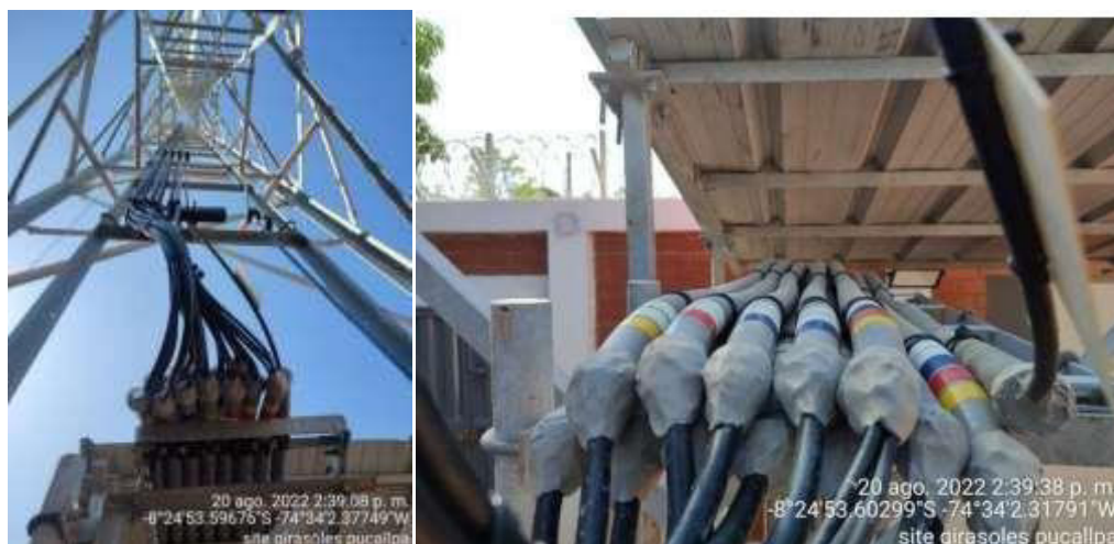
Figura 16. Recorrido de cables de fibra y energía.
