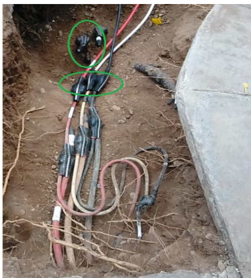
Figura 101. Empalmes de alimentación a la SAB nueva y puntas muertas de SED antigua. Fuente. Autoría propia.
