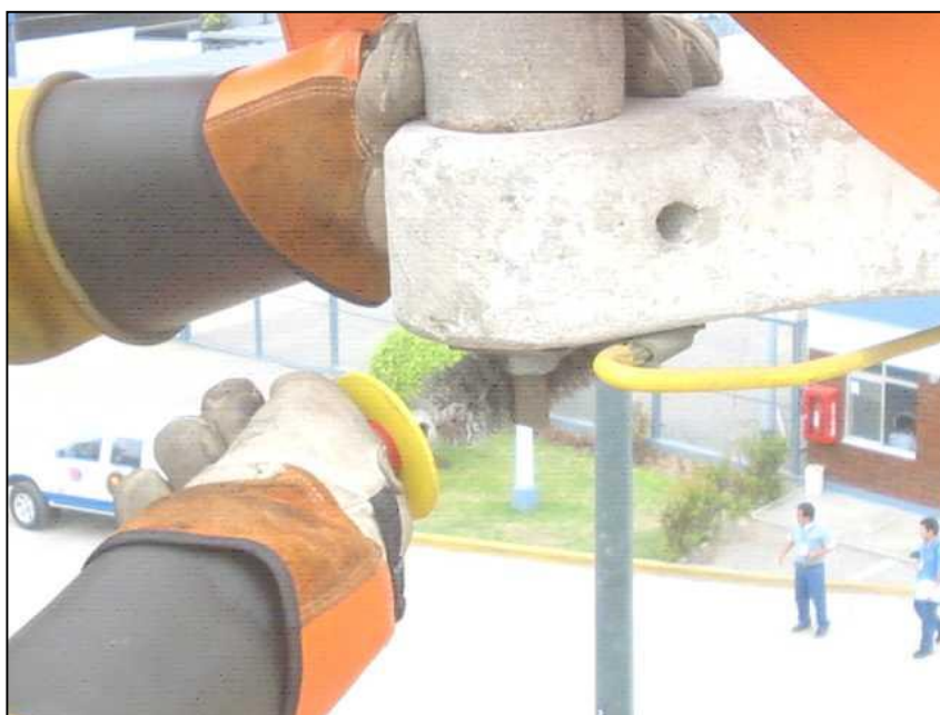
Figura 72. Instalación de puesta a tierra. Fuente. Autoría propia.
