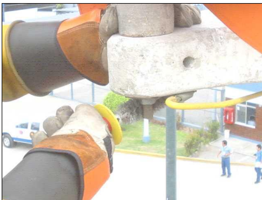
Figura 115. Instalación de puesta a tierra. Fuente. Autoría propia.
