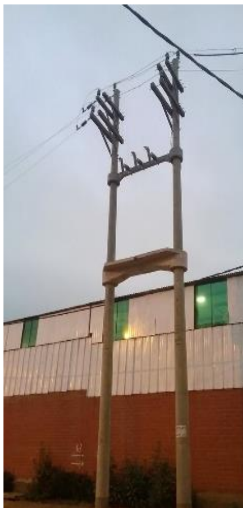
Figura 78. Estructura con seccionadores y sistema de puesta a tierra. Fuente. Autoría propia.
