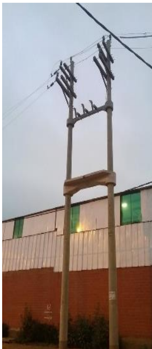
Figura 121. Estructura con seccionadores y sistema de puesta a tierra. Fuente. Autoría propia.
