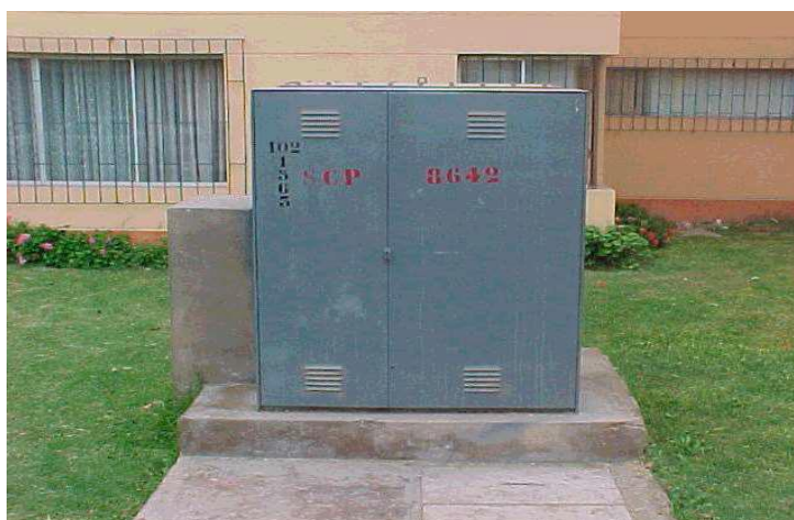
Figura 14. Subestación de distribución compacta tipo pedestal. Fuente: Equipamiento de subestaciones de distribución, Ascencio Charri, Yoel.
