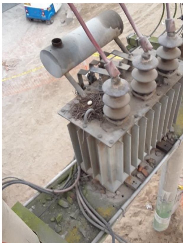
Figura 63. Estado del transformador de la SAB 04805A. Fuente. Autoría propia.
