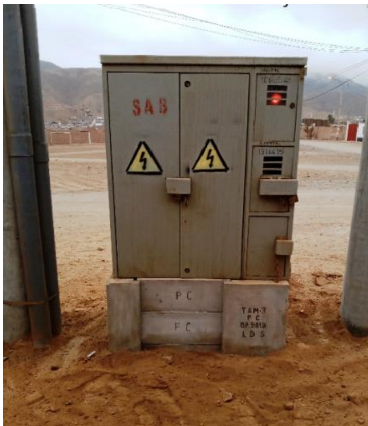
Figura 130. Tablero de distribución a nivel, de la SED. Fuente: Autoría propia.
