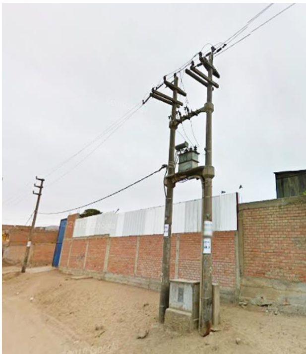
Figura 105. Condiciones encontradas en campo SAB 04805A. Fuente. Autoría propia.
