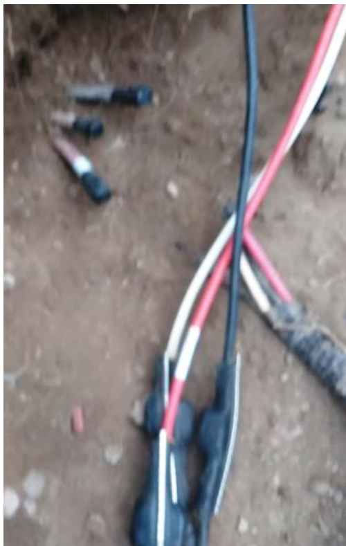
Figura 145. Vista de las puntas muertas retiradas y carga conectada. Fuente. Autoría propia.
