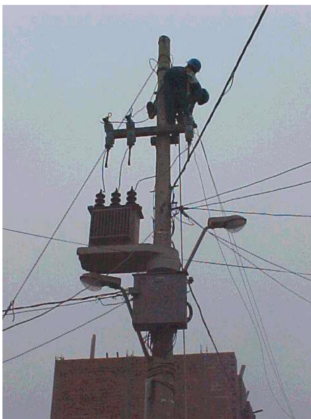
Figura 10. Subestación aérea monoposte. Fuente: Equipamiento de subestaciones de distribución, (Ascencio Yoel., 2019)
