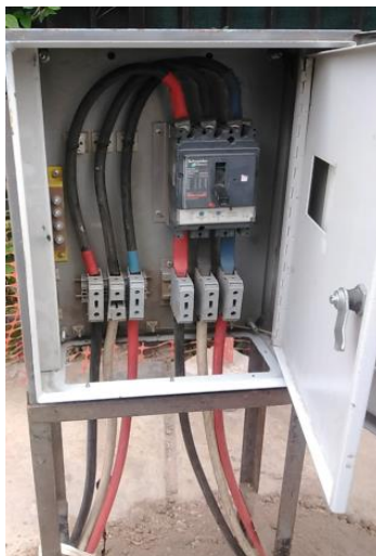
Figura 142. Vista que muestra la llave puente LP-1. Fuente. Autoría propia
