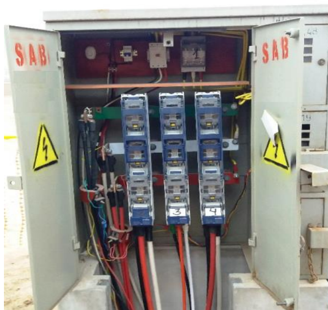
Figura 135. Tablero de distribución de la SED nueva. Fuente. Autoría propia.
