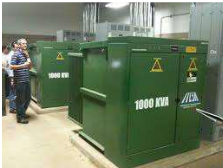
Figura 13. Subestación tipo pedestal de 1000 KVA. Fuente: Subestaciones y tableros de distribución eléctrica. (2020). Extraído de http://aducarte.weebly.com/uploads/5/1/2/7/5127290/subestaciones_y_tableros_de_distribuci%C3%B3n.pdf
