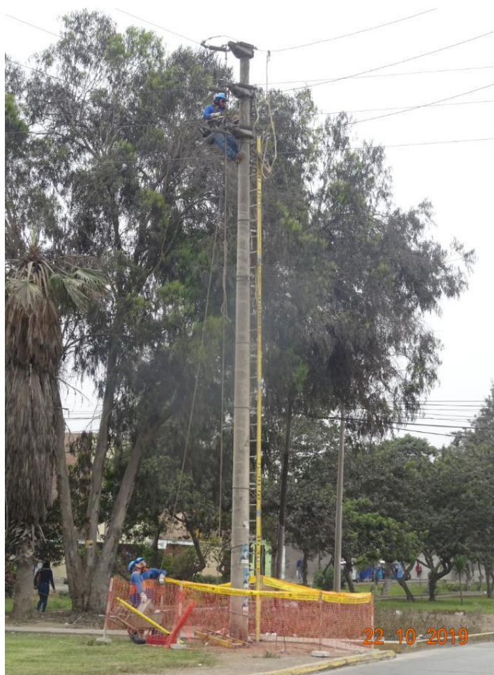
Figura 20. Poste de MT. Fuente: Autoría propia
