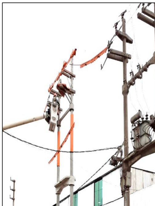
Figura 113. Instalación en ménsulas de madera. Fuente. Autoría propia.
