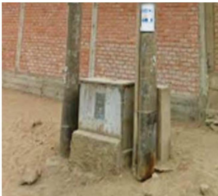
Figura 15. Tablero de Distribución de una SAB. Fuente: Autoría propia.
