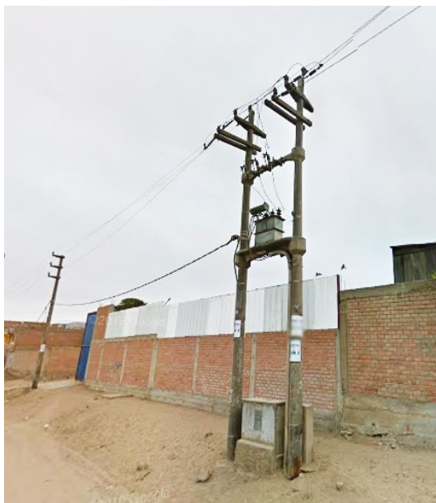
Figura 62. Condiciones encontradas en campo SAB 04805A. Fuente. Autoría propia.
