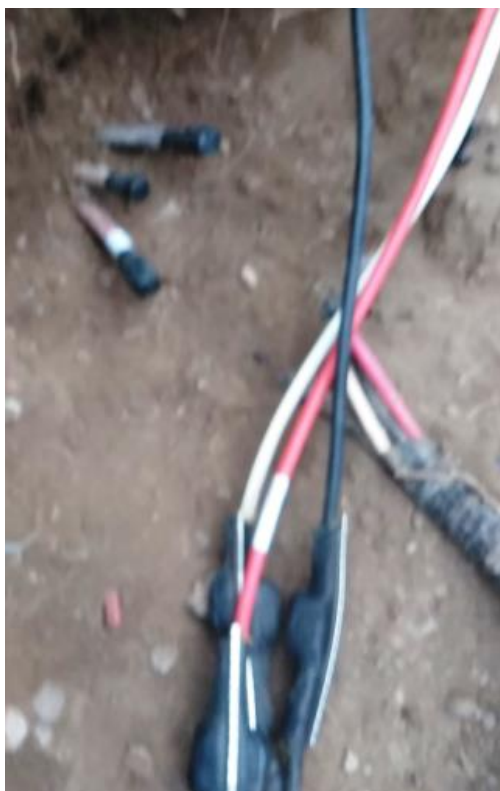
Figura 102. Vista de las puntas muertas retiradas y carga conectada. Fuente. Autoría propia.
