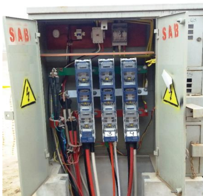
Figura 92. Tablero de distribución de la SED nueva. Fuente. Autoría propia.
