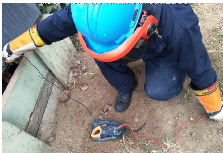
Figura 88. Medición de ausencia de tensión de electrizamiento. Fuente. Autoría propia.
