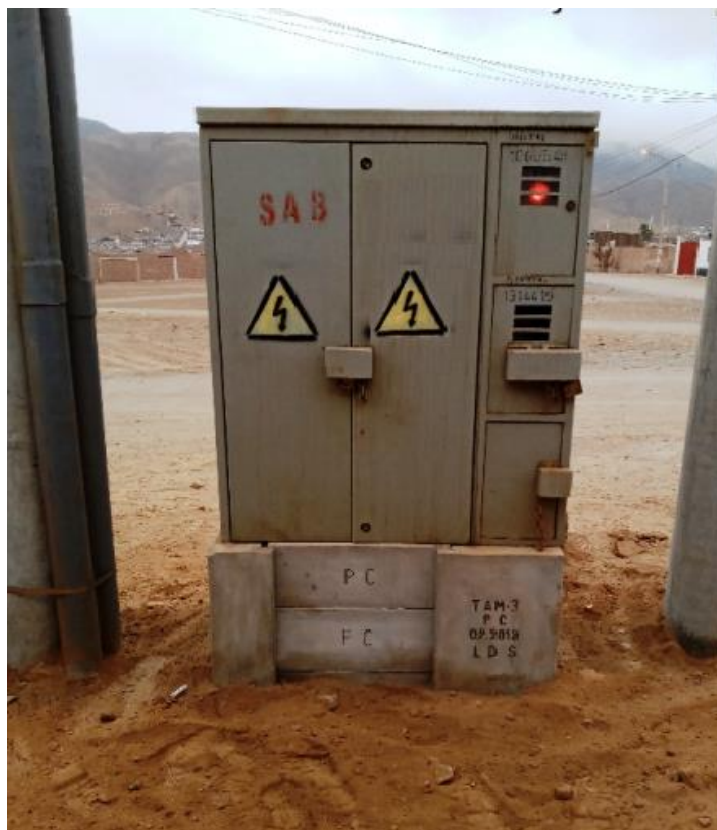
Figura 87. Tablero de distribución a nivel, de la SED. Fuente: Autoría propia.
