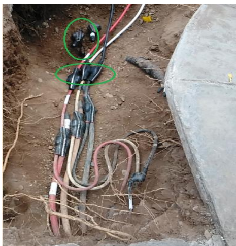
Figura 144. Empalmes de alimentación a la SAB nueva y puntas muertas de SED antigua. Fuente. Autoría propia.
