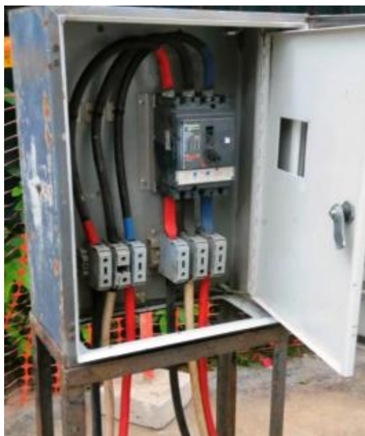
Figura 93. Midiendo secuencia de fases y tensión en las Llaves Puente LP-1 y LP-2. Fuente. Autoría propia.
