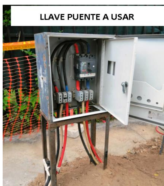
Figura 90. Tablero de llaves puente. Fuente. Autoría propia.
