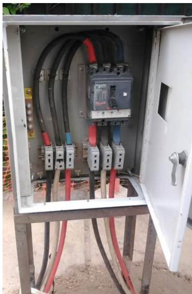
Figura 99. Vista que muestra la llave puente LP-1. Fuente. Autoría propia.
