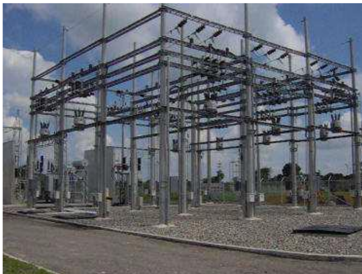
Figura 12. Subestación tipo patio. Fuente: Subestaciones y tableros de distribución eléctrica. (2020). Extraído de: http://aducarte.weebly.com/uploads/5/1/2/7/5127290/subestaciones_y_tableros_de_distribuci%C3%B3n.pdf
