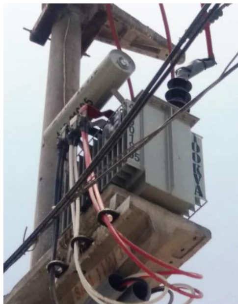
Figura 18. Transformador de distribución. Fuente: Autoría propia
