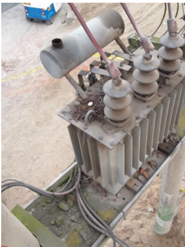
Figura 106. Estado del transformador de la SAB 04805A. Fuente. Autoría propia.
