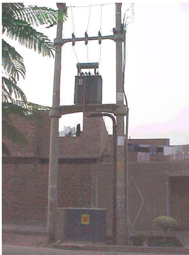
Figura 11. Subestación aérea biposte. Fuente: Equipamiento de subestaciones de distribución, Ascencio Yoel., 2019
