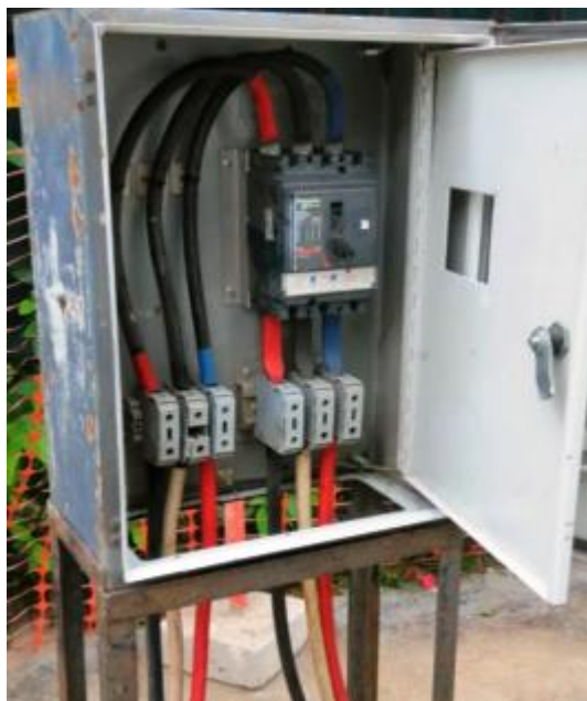
Figura 136. Midiendo secuencia de fases y tensión en las Llaves Puente LP-1 y LP-2. Fuente. Autoría propia.
