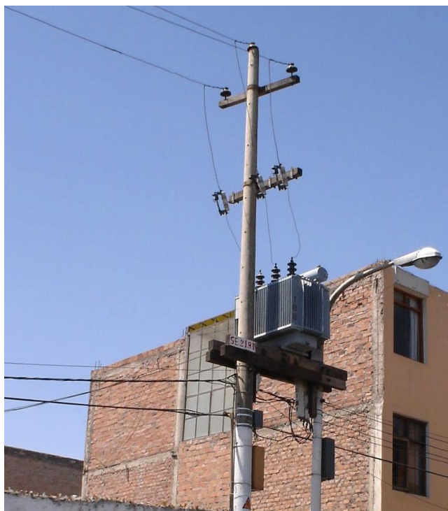
Figura 6. Red de distribución primaria y secundaria. Fuente: Curso de capacitación “Redes de distribución Eléctrica” Instituto Tecnológico TECSUP
