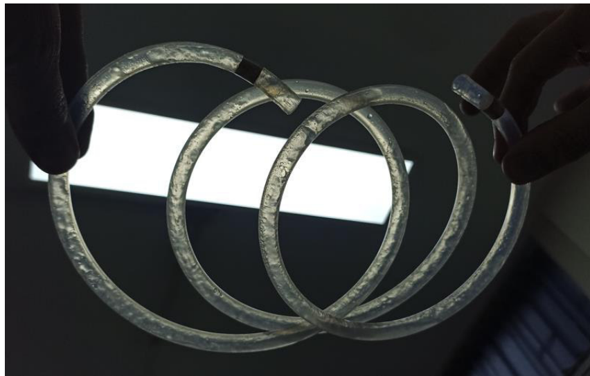
Figura 8 Ductos de aire con presencia de parafina
