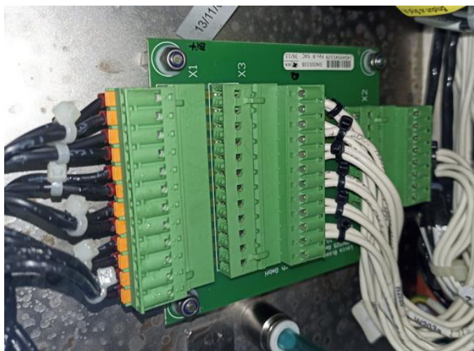
Figura 16 Tarjeta electrónica del sistema de temperatura
