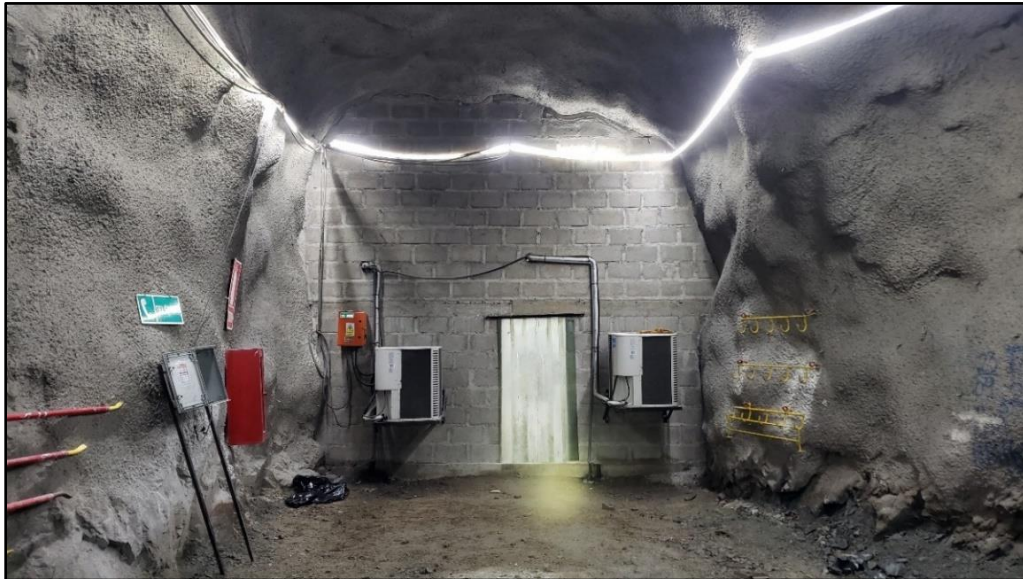
Figura 61: Cámara de recuperación con acondicionamiento de aire – Exterior.
