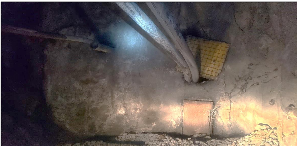
Figura 42: Tapón con fugas de aire – RB_2.
