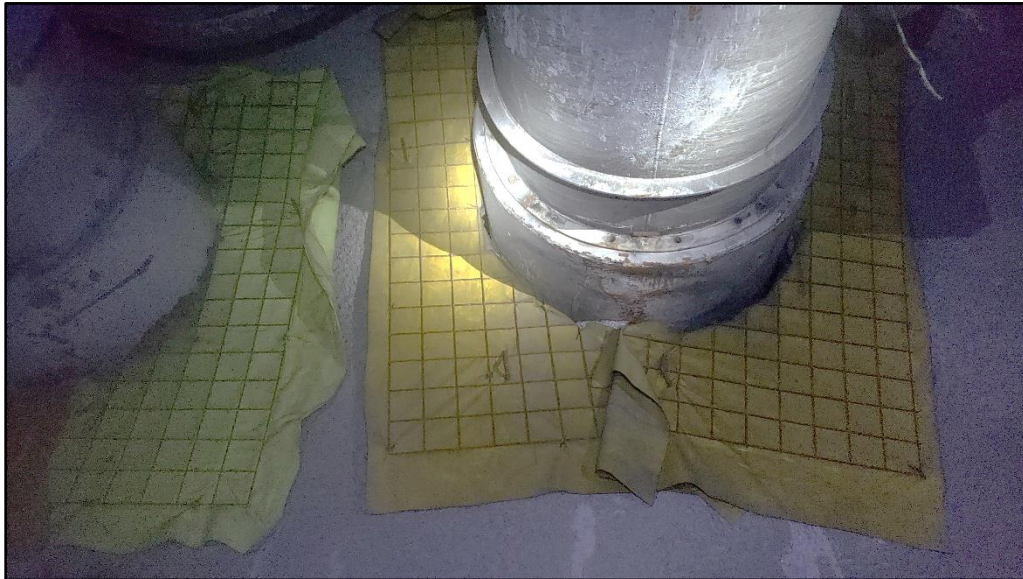
Figura 46: Hermetizado de ventiladores con malla y manga - Pozo_8.
