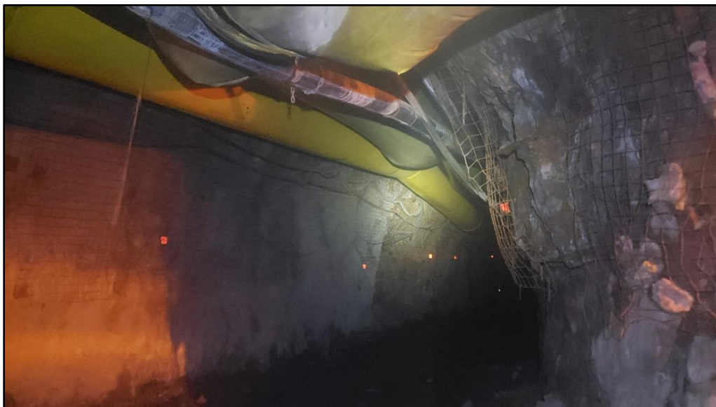
Figura 34: Presencia de vapor de agua.
