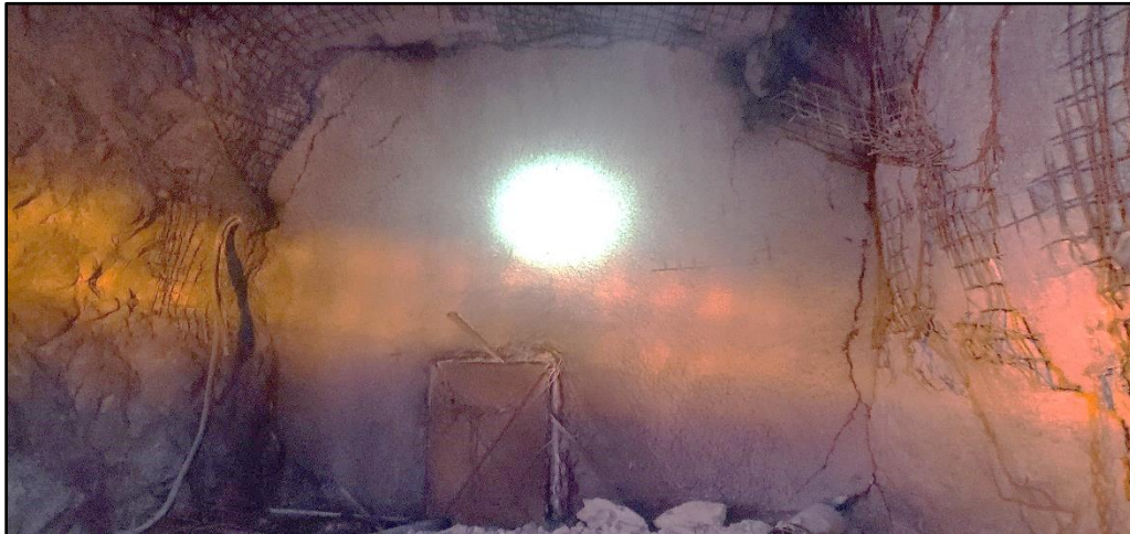
Figura 43: Tapón de acceso con fugas de aire - RB_1.
