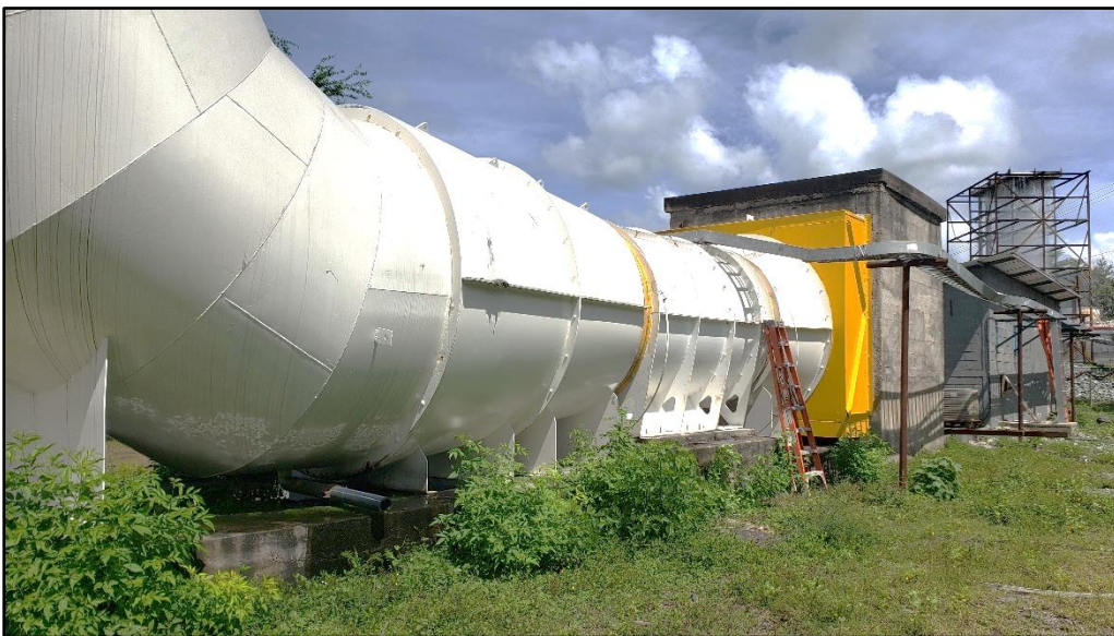
Figura 20: Ventilador extractor de aire viciado - RB_1.
