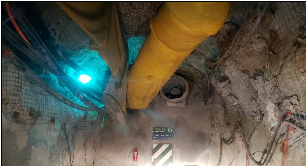
Figura 45: Ventilador inoperativo generando recirculación de aire caliente - Pozo_8.
