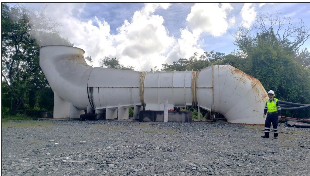
Figura 24: Ventilador extractor de aire viciado – RB_1.
