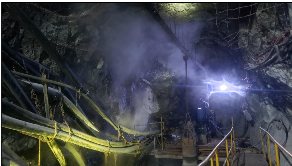
Figura 36: Emisión de vapor en poza de bombeo.
