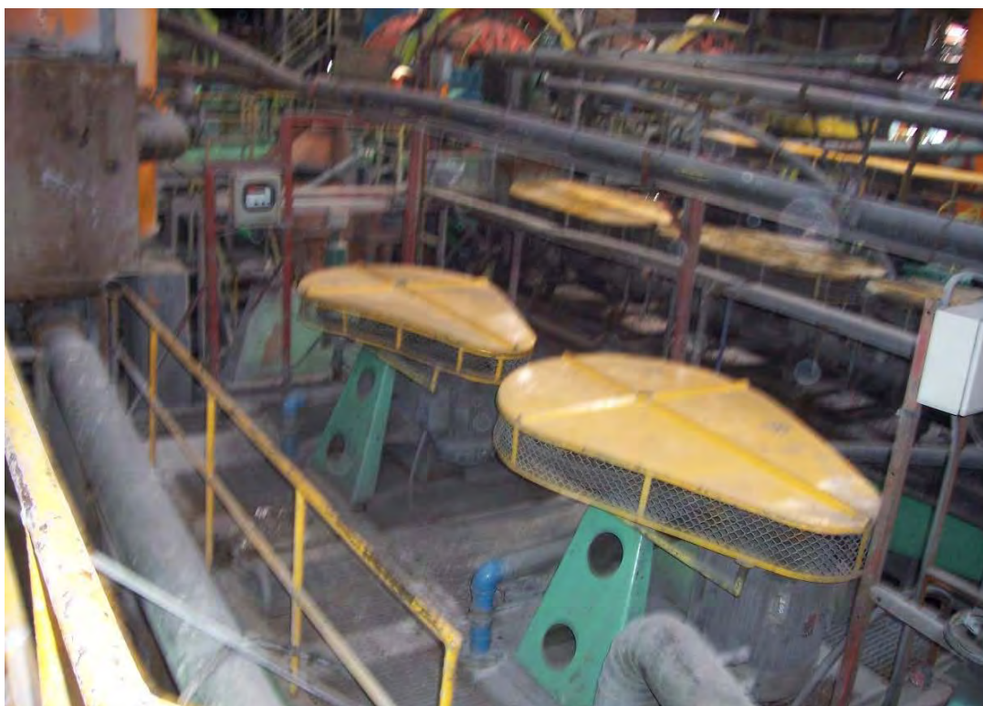
Foto 5-2: CELDAS DE FLOTACION DEL CIRCUITO DE Zn.
