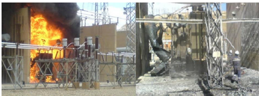
Figura 21. Incendio de un transformador de potencia en aceite mineral, Subestación Oroya, 2010 Nueva Fuente: COES informe de perturbaciones del SEIN
