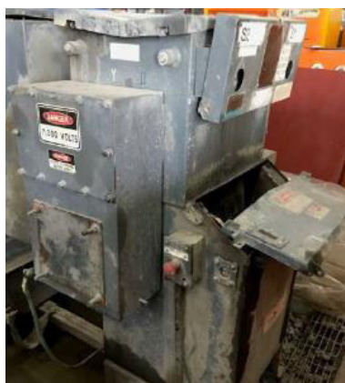
Figura 27. Después de la falla del Transformador de potencia en aceite vegetal, Sudafrica 2006 , Fuente: Aplicación de Aceite Vegetal en Transformadores-cargill - Agosto 2019.Pdf.
