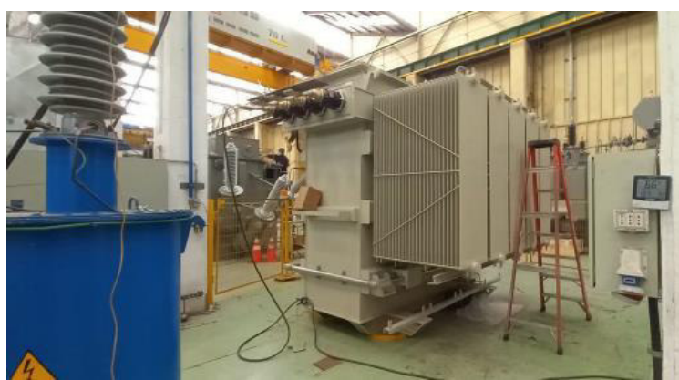
Figura 42. Pruebas eléctricas, Fuente: propia
