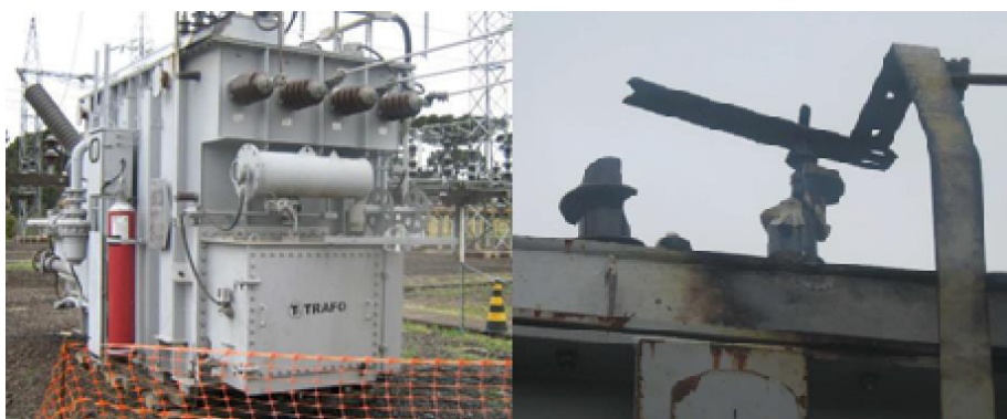
Figura 26. Antes y después de la falla del Transformador de potencia Brasil 2002 , Fuente: Aplicación de Aceite Vegetal en Transformadores-cargill - Agosto 2019.Pdf.
