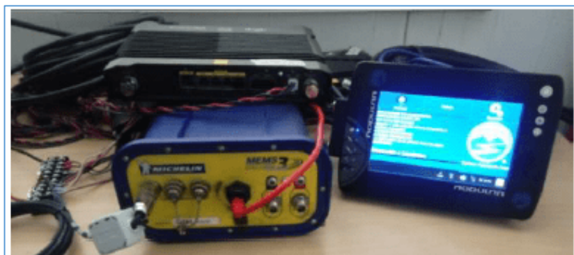
Figura 39: Migración de equipos a la nueva red LTE. Fuente: Comtecsa (2022).
