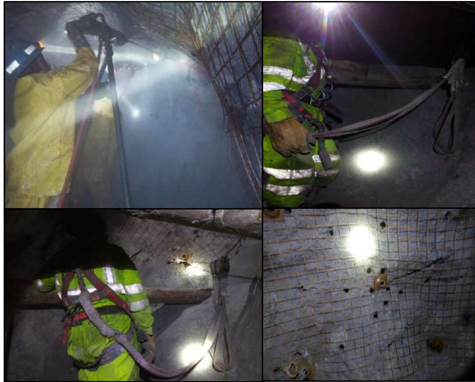
Fotografía N° 19. Perforación en chimenea
