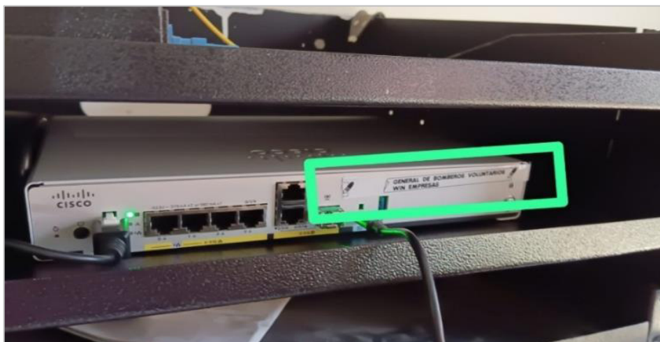
Figura 18: Instalación de CPE Cisco 1121-4P en Sede Remota 1. Fuente. Imagen tomada durante la implementación del proyecto en la sede Remota 1, con equipo CPE Cisco 1121-4P. WIN Empresas (2024).
