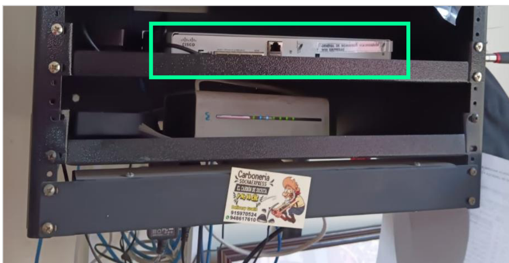
Figura 21: Instalación de CPE Cisco 1121-4P en la Sede Remota 4. Fuente. Imagen tomada durante la implementación del proyecto en la sede Remota 4, con equipo CPE Cisco 1121-4P. WIN Empresas (2024).
