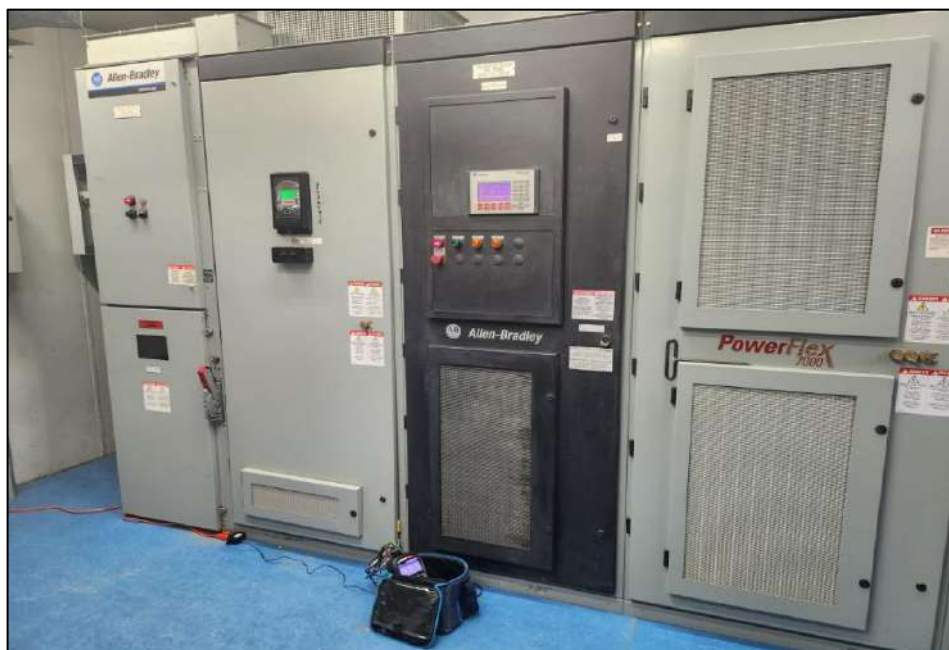
Figura 60 Equipo de medición en el VFD 1140HP. Fuente. Elaboración propia
