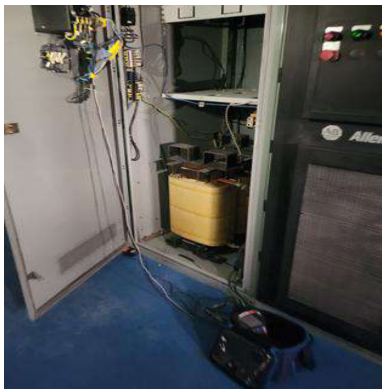
Figura 96 Reactor de entrada VFD 1140HP DE LA SALA 1200-ER-021.
