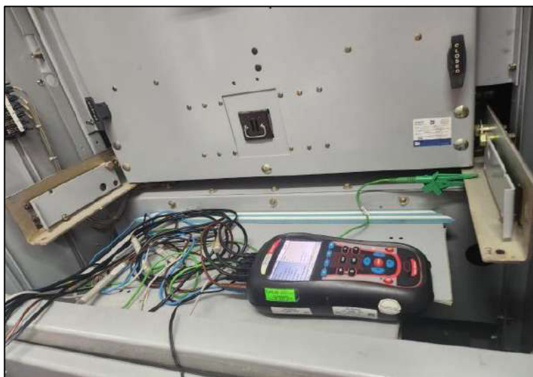
Figura 33 Equipo de medición instalado en la sala 1100-ER-011, lado 4.16kV. Fuente. Elaboración propia
