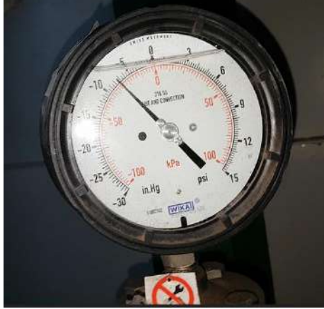
Figura 84 Mano-Vacuómetro: Presión de succión antes de la bomba es -7.5 PSI. Fuente. Fotografía propia.
