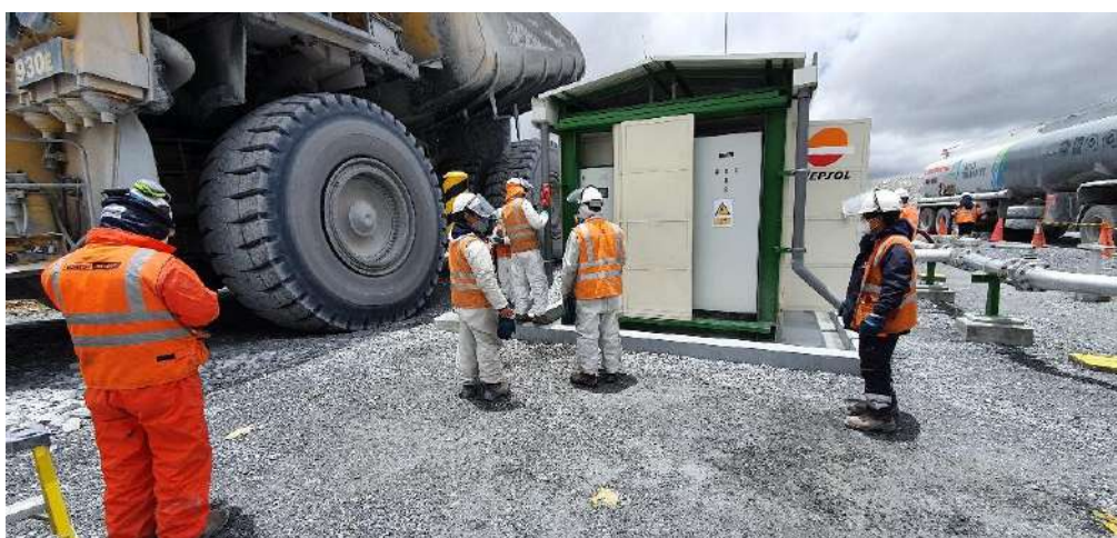
Figura 3 Planta de abastecimiento de combustible en minería. Fuente. Fotografía propia.
