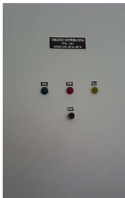
Figura 125 Exterior de gabinete de fuerza. Fuente. Fotografía propia.
