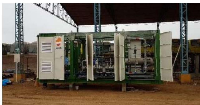
Figura 233 Zona trasera de Skid. Fuente. Fotografía propia.
