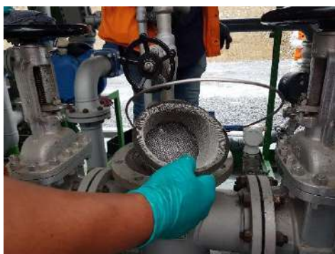
Figura 97 Limpieza de canastilla de filtro. Fuente. Fotografía propia.
