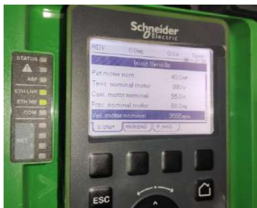
Figura 122 Parámetros de variador VDF. Fuente. Fotografía propia.
