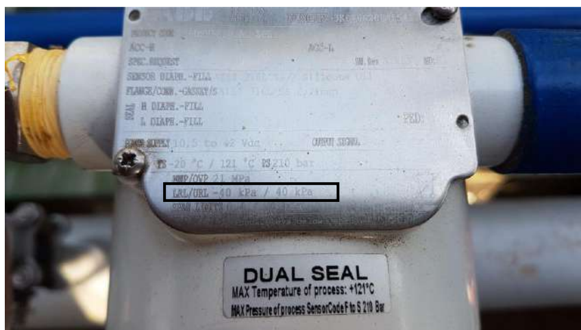
Figura 35 Placa de Instrumento FIT. Fuente. Fotografía propia.
