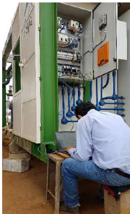
Figura 146 Programación de PLC. Fuente. Fotografía propia.
