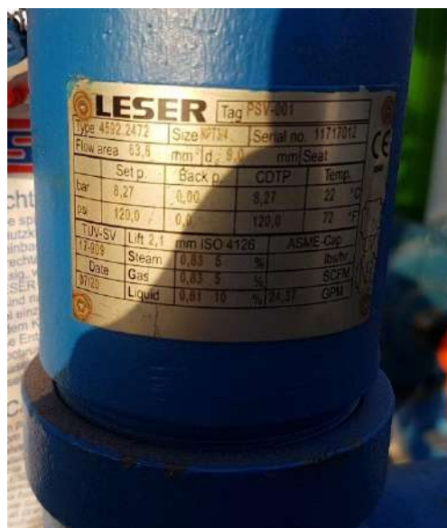
Figura 105 Placa de válvula de alivio para filtro micrónico. Fuente. Fotografía propia.
