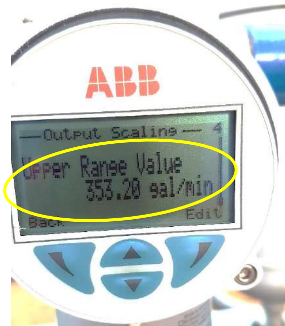
Figura 40 Configuración de flujo máximo. Fuente. Fotografía propia.
