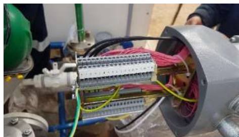
Figura 121 Conexión de equipos. Fuente. Fotografía propia.
