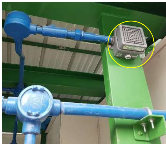
Figura 49 Alarma sonora cuando el filtro micrónico supera 40 psi. Fuente. Fotografía propia.
