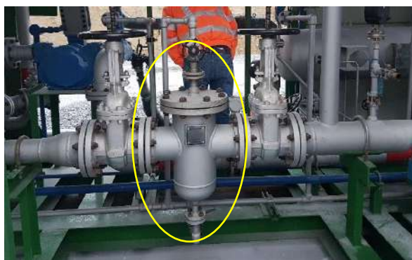
Figura 96 Filtro tipo canasta en interior de Skid. Fuente. Fotografía propia.
