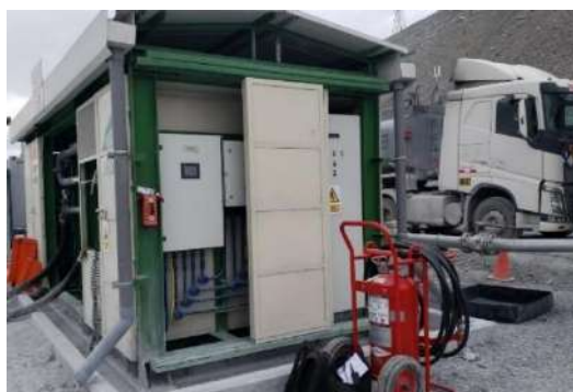
Figura 230 Zona de tableros de Skid. Fuente. Fotografía propia.
