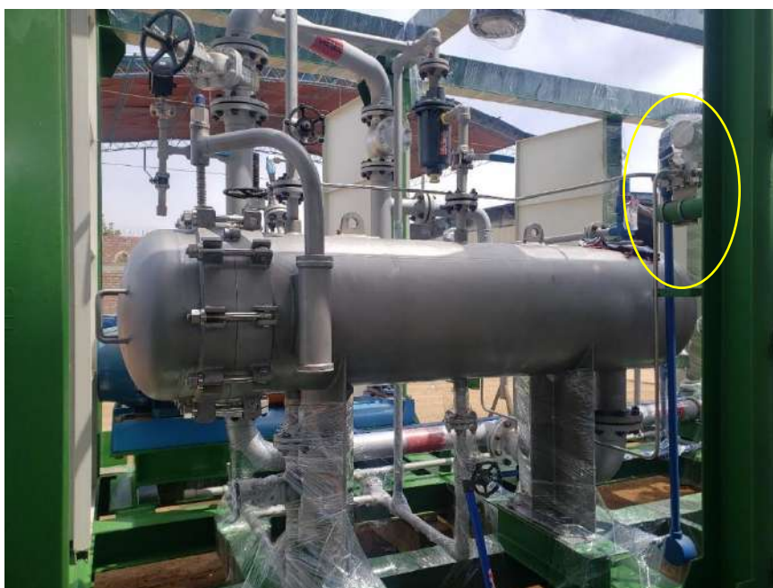
Figura 44 Filtro micrónico conectado a transmisor de presión diferencial. Fuente. Fotografía propia.
