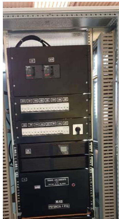
Figura 133 Equipos en gabinete TFC-001. Fuente. Fotografía propia.
