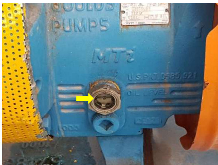
Figura 88 Mantener nivel de aceite en bomba. Fuente. Fotografía propia.
