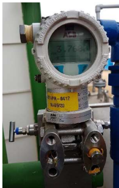
Figura 213 Funcionamiento de DPIT-001. Fuente. Fotografía propia.
