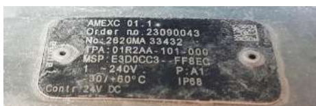
Figura 69 Placa de unidad de mando AM de válvula motorizada. Fuente. Fotografía propia.
