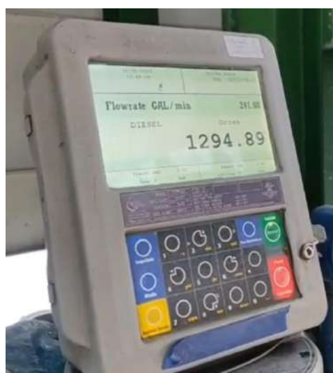
Figura 222 Medidor volumétrico terminando operación, muestra flujo y acumulado. Fuente. Fotografía propia.
