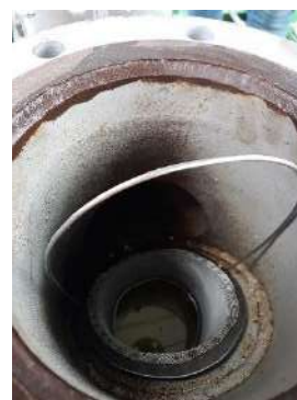
Figura 98 Interior de filtro tipo canasta. Fuente. Fotografía propia.
