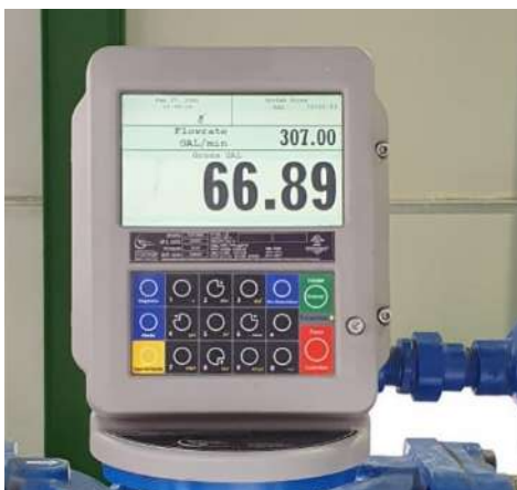
Figura 67 Medidor volumétrico en operación, se muestra flujo y acumulado. Fuente. Fotografía propia.
