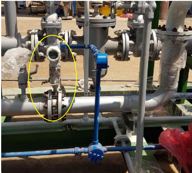
Figura 33 Medidor de flujo diferencial instalado en Skid. Fuente. Fotografía propia.
