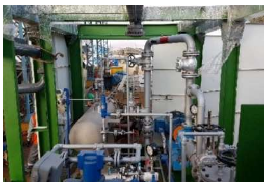
Figura 231 Interior de Skid. Fuente. Fotografía propia.
