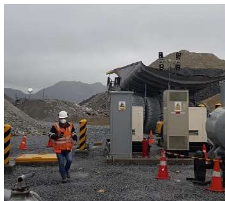
Figura 235 Patio de motogeneradores Cummins de 100 kW (134.1 HP). Fuente. Fotografía propia.
