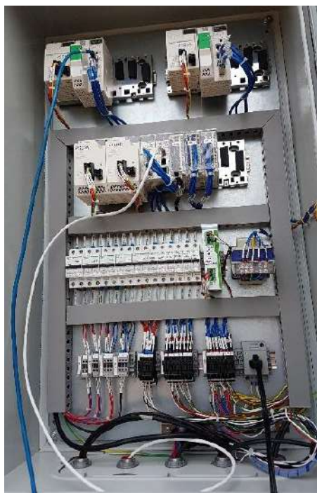
Figura 145 Interior de tablero control TC-001. Fuente. Fotografía propia.
