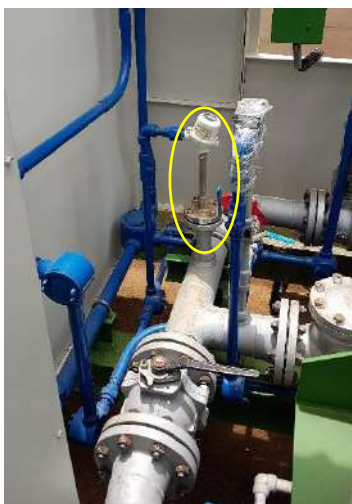
Figura 50 Instrumento TIT instalado. Fuente. Fotografía propia.
