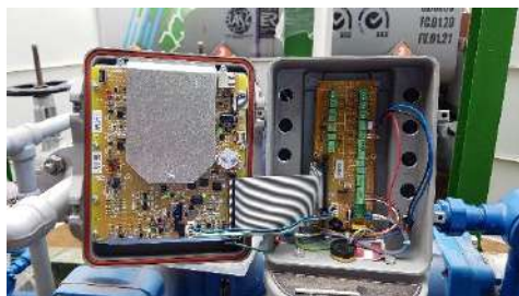
Figura 120 Conexión de equipos. Fuente. Fotografía propia.
