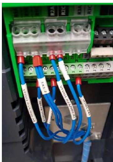
Figura 128 Conexionado de control de ATV630. Fuente. Elaboración propia.
