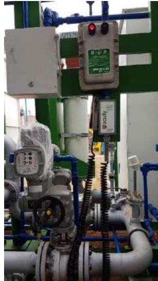
Figura 106 Detector de puesta tierra-Scully. Fuente. Fotografía propia.
