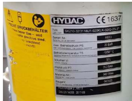
Figura 110 Placa de amortiguador de pulsaciones. Fuente. Fotografía propia.
