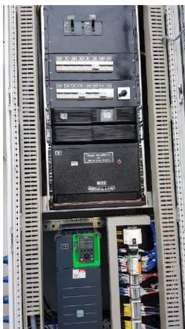
Figura 124 Interior de gabinete de fuerza. Fuente. Fotografía propia.
