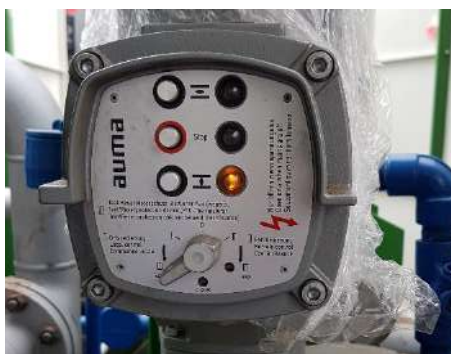
Figura 71 Panel de operación en modo automático. Fuente. Fotografía propia.
