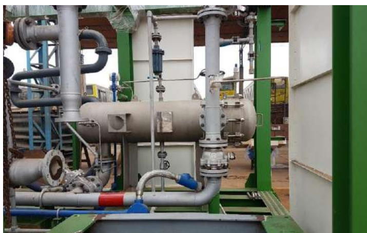
Figura 99 Filtro micrónico. Fuente. Fotografía propia.
