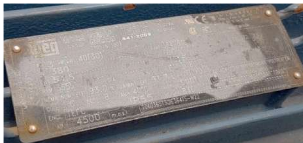
Figura 83 Placa de motor. Fuente. Fotografía propia.
