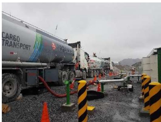
Figura 234 Interconexión de camiones cisterna a Skid. Fuente. Fotografía propia.
