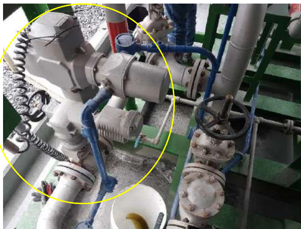
Figura 68 Válvula motorizada en Skid. Fuente. Fotografía propia.
