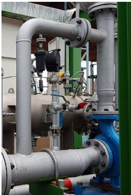
Figura 86 Interconexión línea descarga y succión. Fuente. Fotografía propia.
