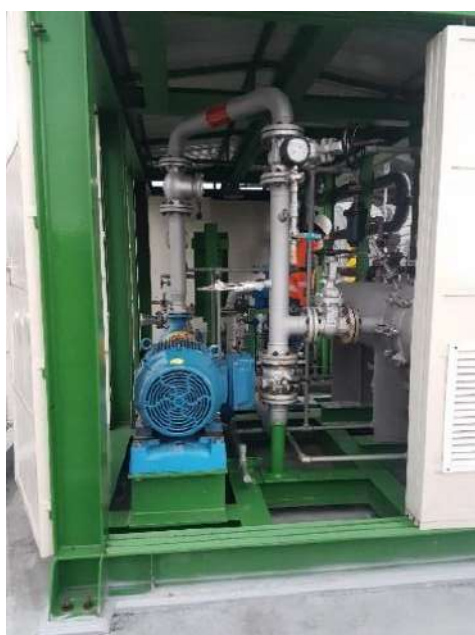
Figura 232 Zona lateral de Skid. Fuente. Fotografía propia.
