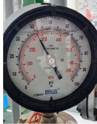
Figura 85 Manómetro: Presión de descarga después de la bomba es 40 PSI. Fuente. Fotografía propia.
