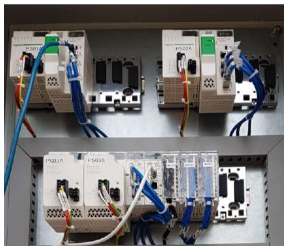
Figura 227 Sistema redundante M580 en modo Hot Standby. Fuente. Fotografía propia.
