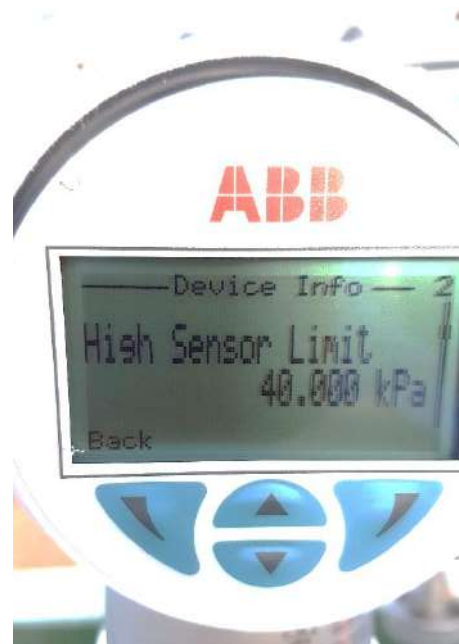
Figura 41 Máximo rango de presión diferencial a detectar. Fuente. Fotografía propia.
