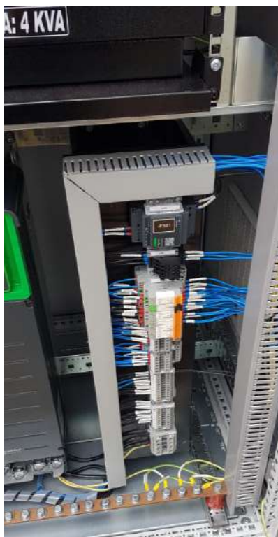
Figura 132 Regleta de borneras del gabinete TFC-001. Fuente. Fotografía propia.
