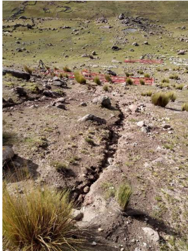
Figura 59 Bentonita lavada por la lluvia en la zona norte del pad de lixiviación.
