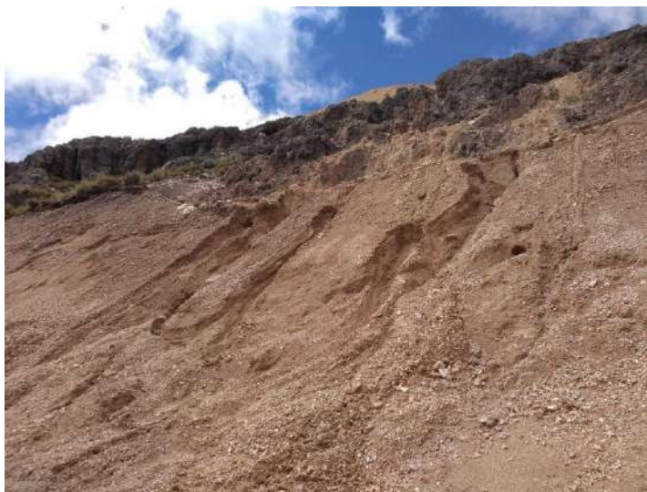
Figura 39 Cárcavas en la zona sur del pad de lixiviación.
