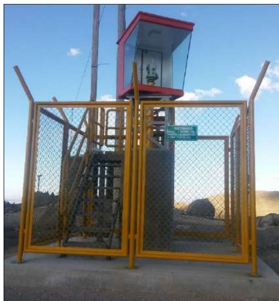
Figura 13 Estación de monitoreo automatizado.
