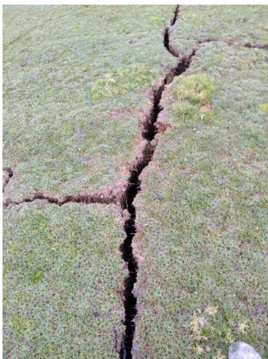
Figura 42 Grietas zona noreste de las pozas.
