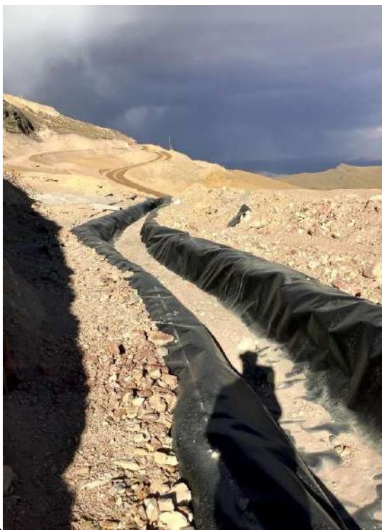
Figura 40 Canal perimetral zona sur del pad de lixiviación
