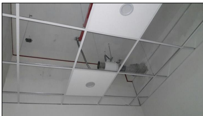
Figura 41. Extractor Helicocentrífugo en Hospital Regional de Moquegua. Elaboración propia.
