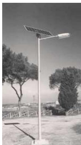
Figura 24. Alumbrado Público con Paneles Fotovoltaicos (ASIF, 2006)
