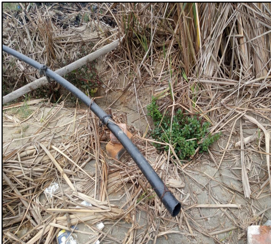
Figura 34. Restos de la instalación de extracción de las aguas de la laguna la Encantada.
