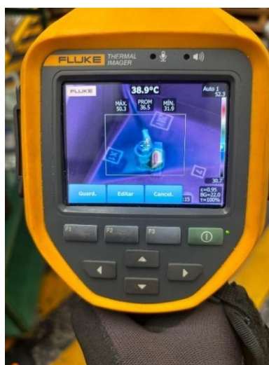
Figura 98: Mediciones restantes temperatura fase 1 en falso contacto
