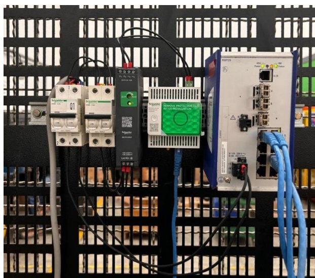
Figura 70: Equipos de comunicación
