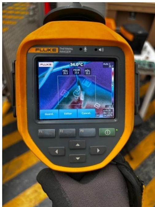
Figura 89: 2da medición temperatura de fase 1
