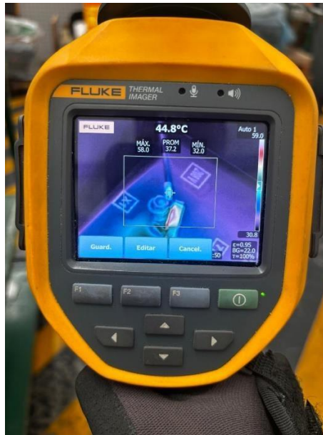
Figura 96: 3era medición temperatura fase 1 en falso contacto
