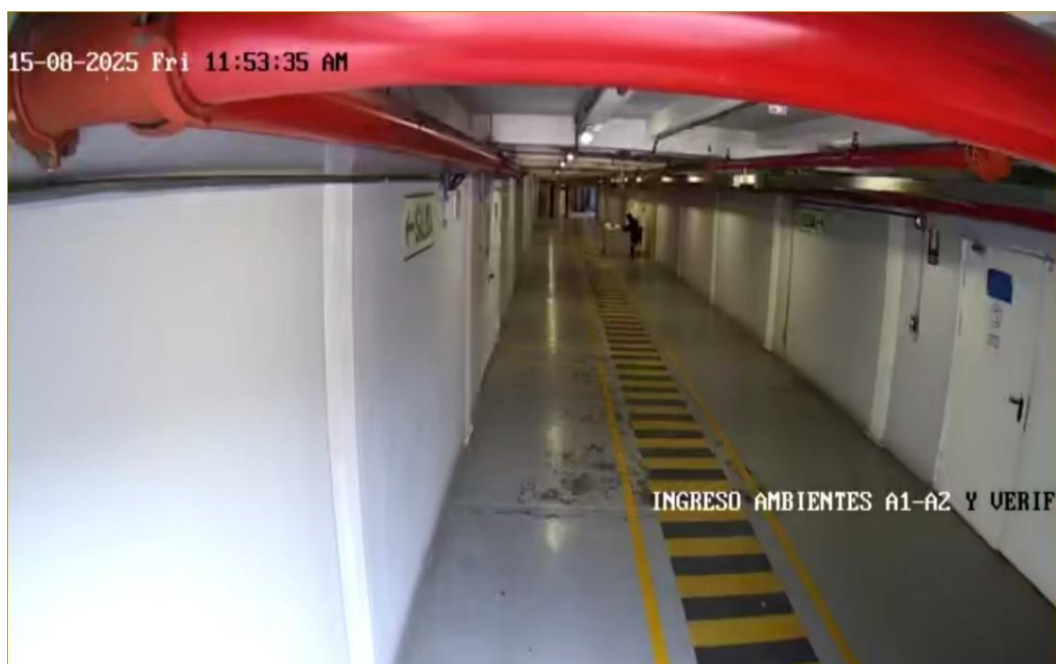
Figura B2 Imagen cámara puertas de acceso ambientes de conservación.
