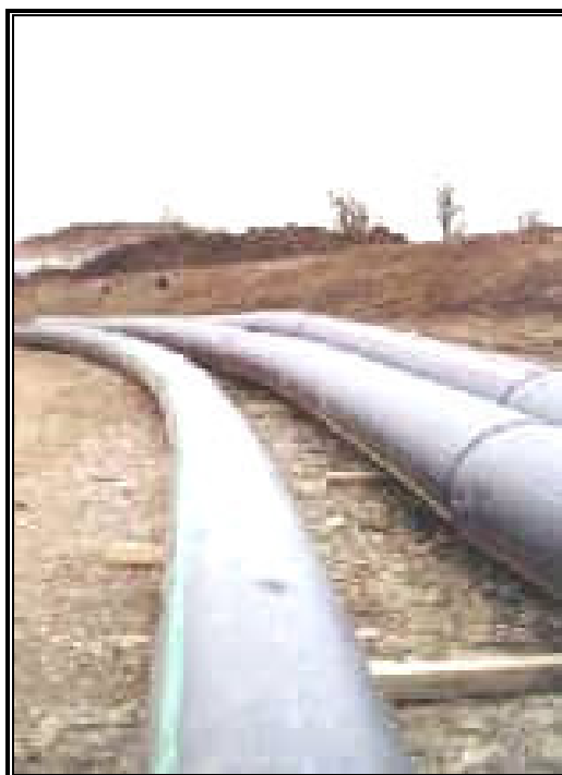
Fig.6 Tuberías de HDPE.
