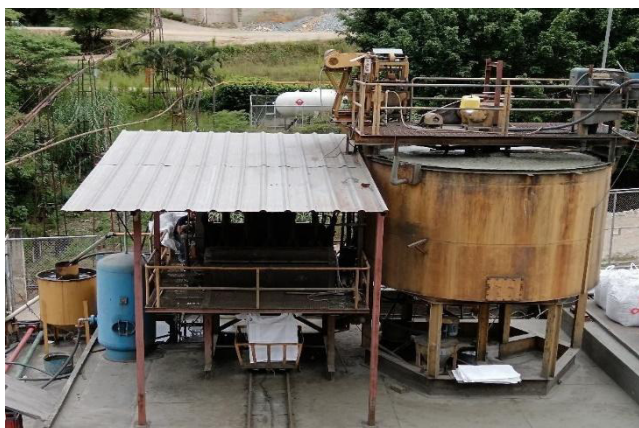
Circuito de espesamiento y filtrado
