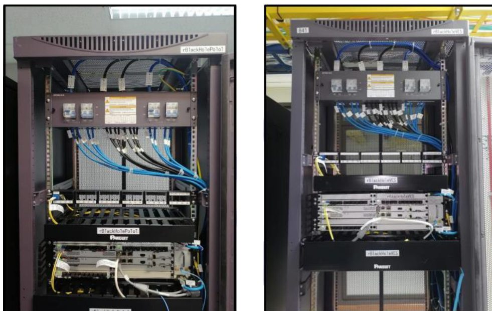
Figura 8: Vista de equipos instalados en DCs. Fuente: Elaboración propia
