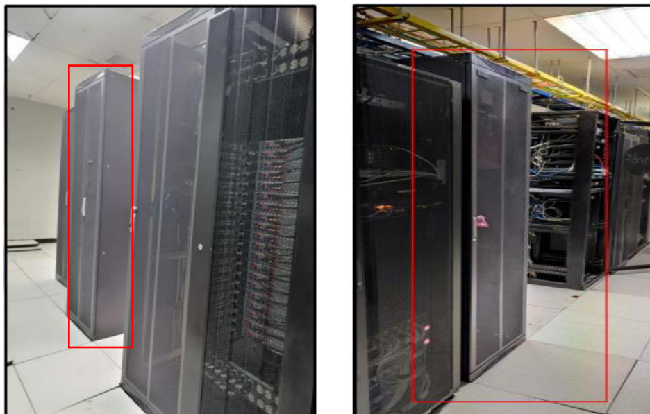
Figura 7: Gabinetes instalados en DCs. Fuente: Elaboración propia
