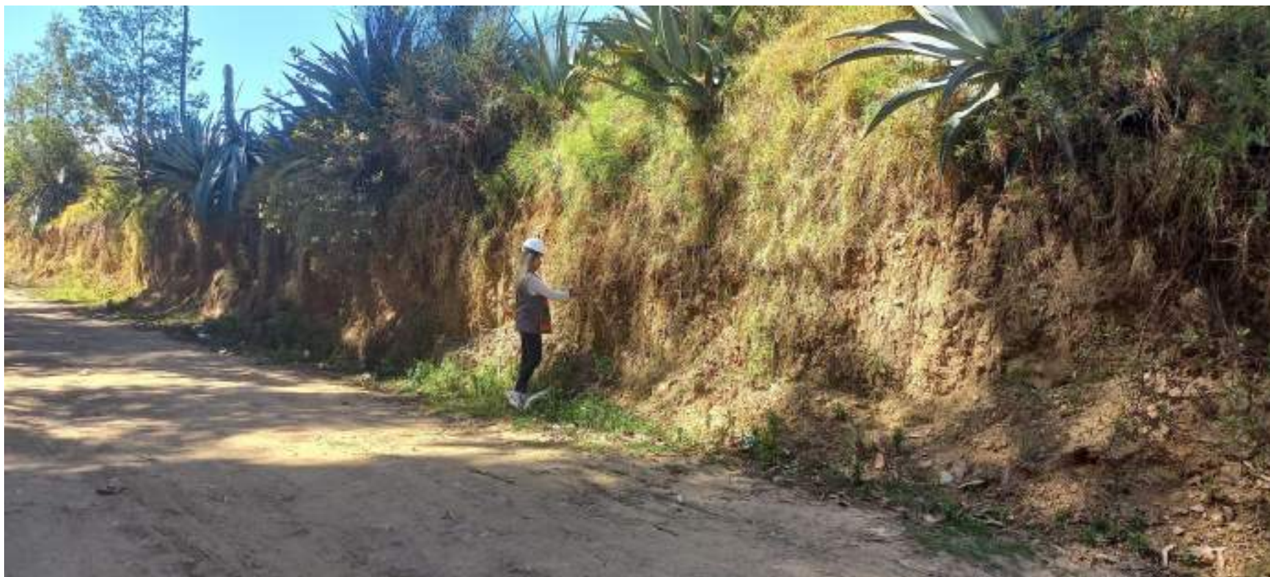
Foto N°3: Vista lateral izquierda del talud de estudio.
