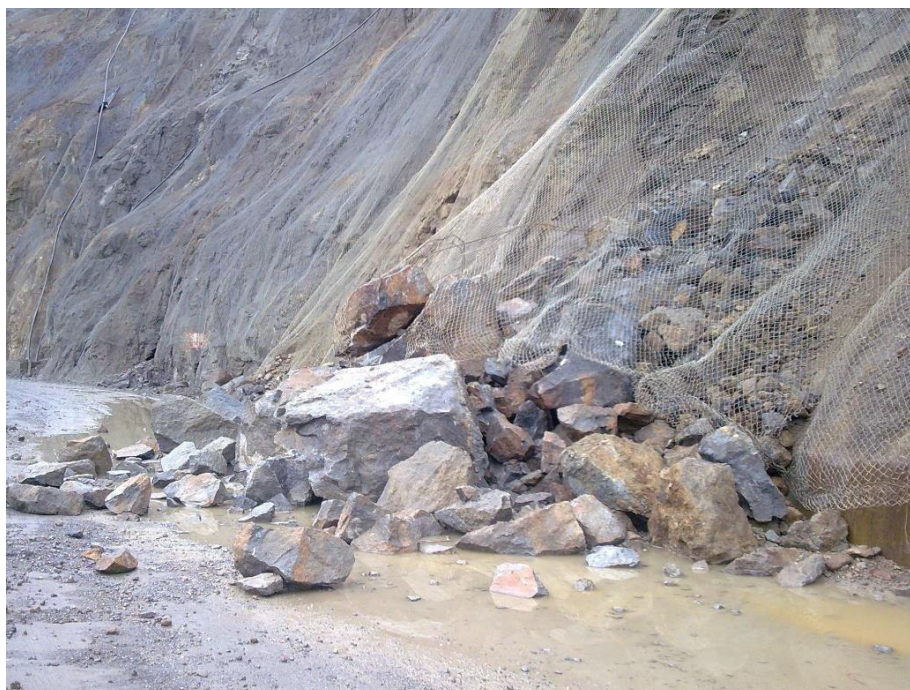
Figura 13. Material de colapso en Rampa Principal del Nv. 800
