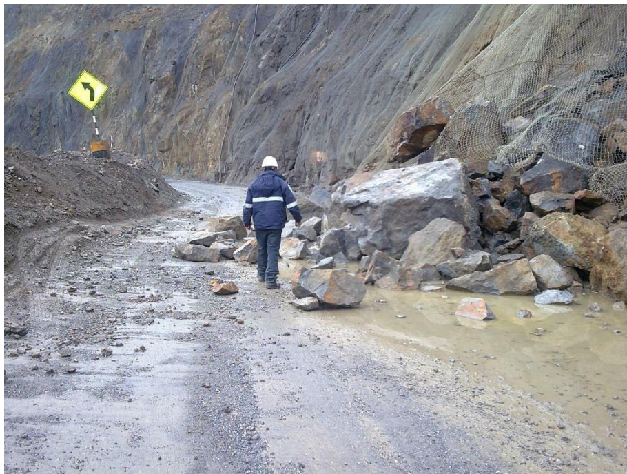
Figura 12. Material de colapso en Rampa Principal del Nv. 800
