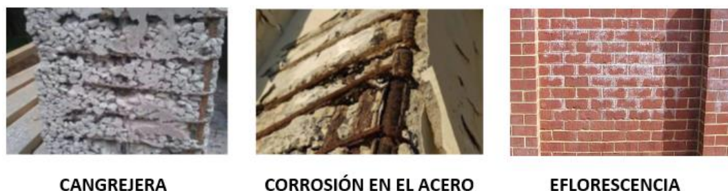
Figura 8: Factores degradantes en viviendas de albañilería confinada.
