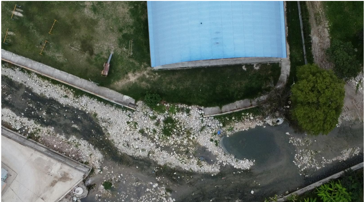
Figura 38 Destrucción del muro de encausamiento en Lajas
