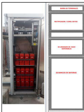
Ilustración 2 Validación de energía en Site Caylloma
