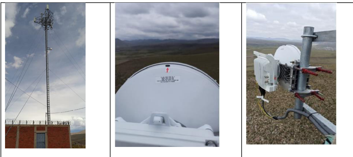
Antena de servicio instalada en Site de Claro para aprovisionamiento de Internet Corporativo
