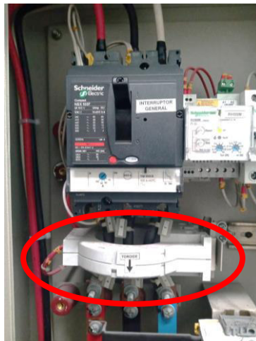
Figura 25: Toroide en Tablero General. Fuente: Archivo fotográfico de Clear Channel.
