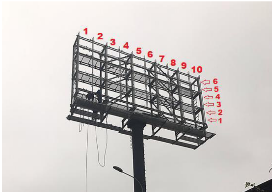
Figura 42: Torre unipolar – estructura metálica. Fuente: Archivo fotográfico de Clear Channel.
