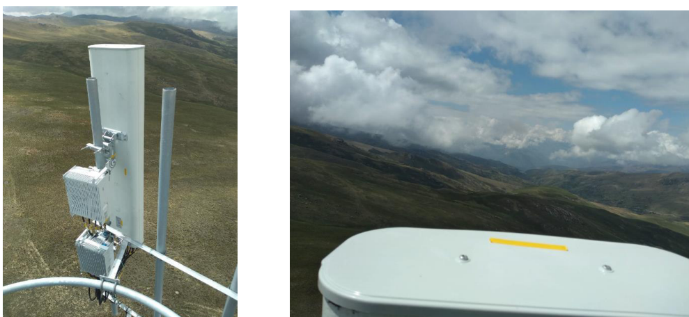
Figura 32: Vista panorámica instalación después - Sector 2. Fuente: Elaboración propia.
