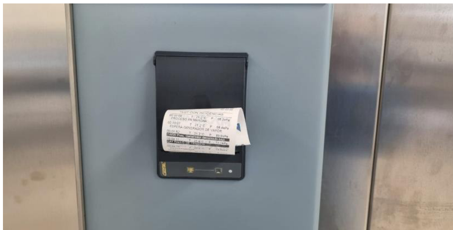
Figura 30 Verificación de funcionamiento de Impresora de esterilizador a vapor. Fuente: Elaboración propia.
