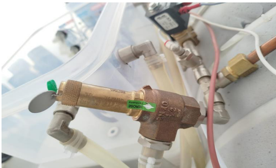
Figura 29 Verificación de funcionamiento de válvula de seguridad de generador de vapor. Fuente: Elaboración propia.
