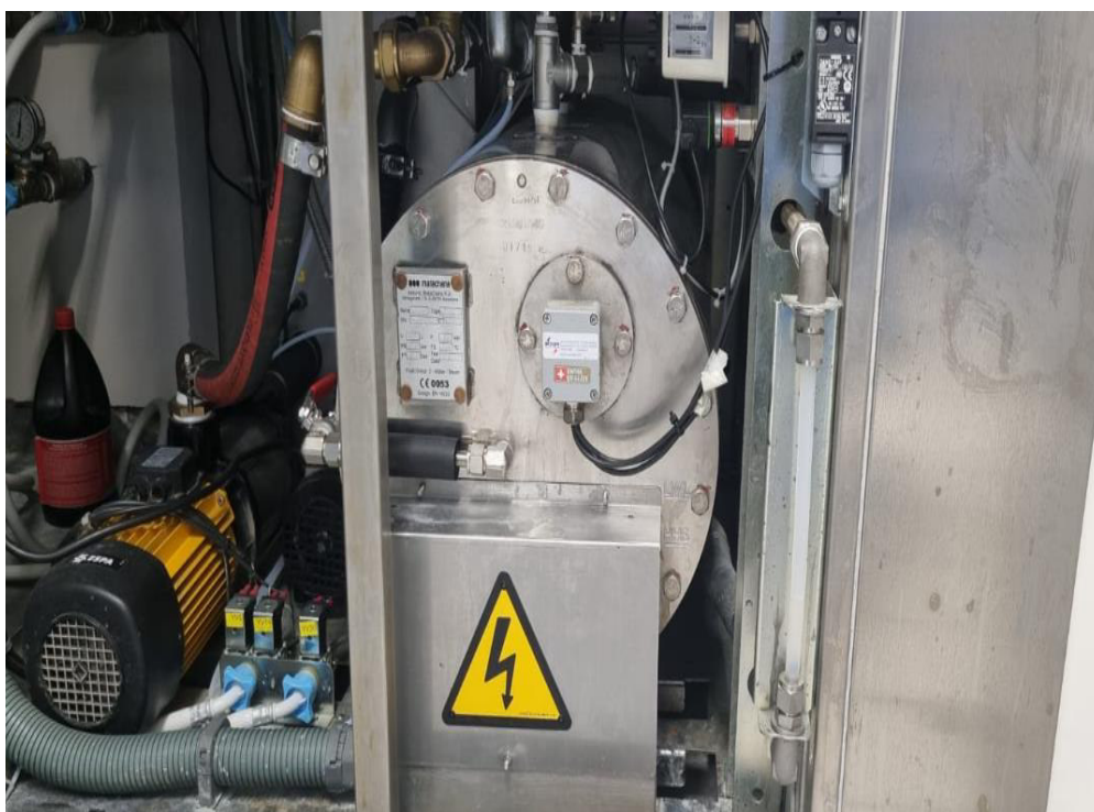
Figura 9 Generador a Vapor. Fuente. Elaboración propia
