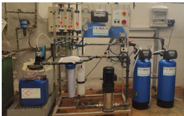
Figura 7 Sistema de osmosis Inversa para suministro de generador de vapor. Fuente. Elaboración propia
