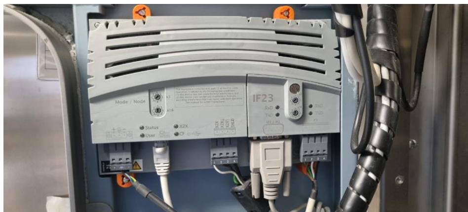
Figura 32 Verificación de cableado, conexión de red y configuración de dirección IP de servidor de Datos. Fuente: Elaboración propia.
